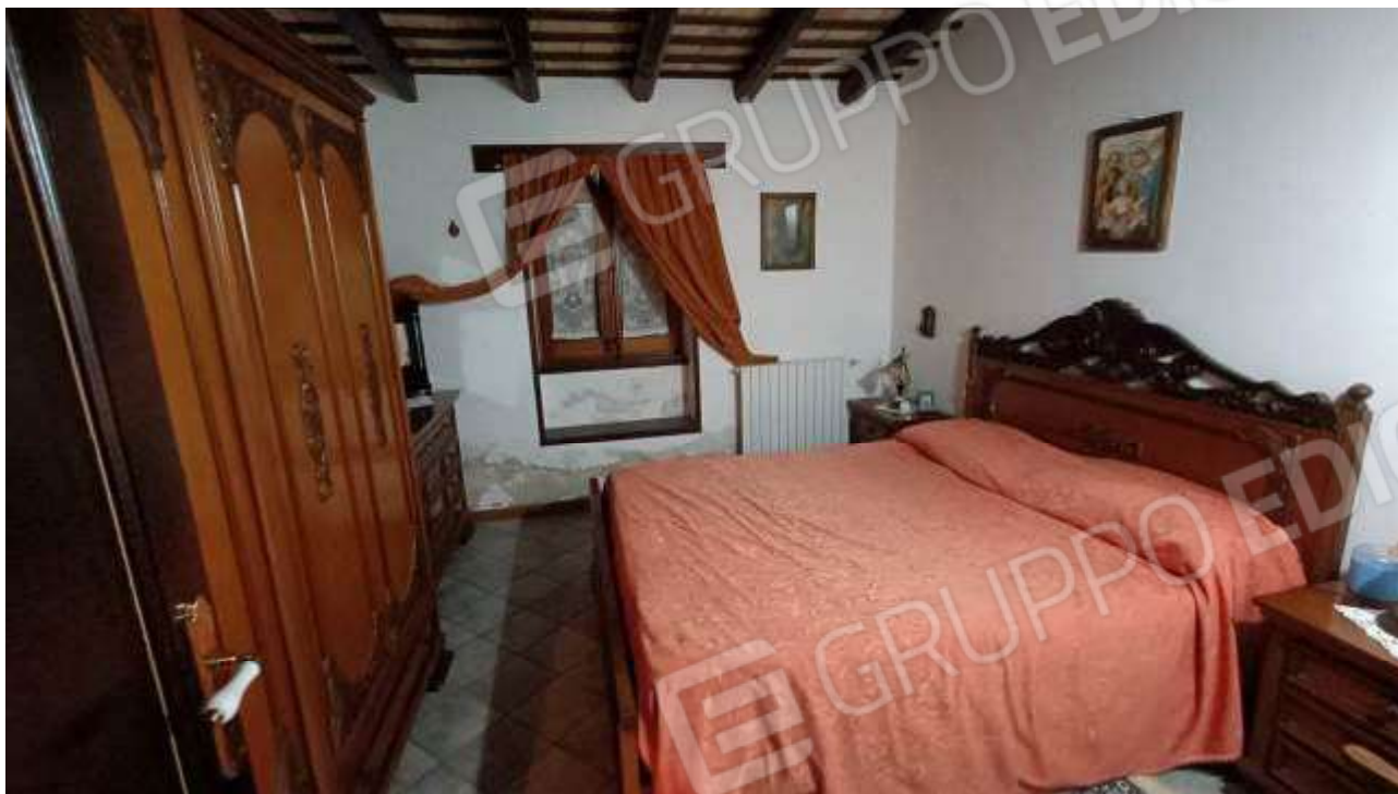
FOTO 25 – Camera (9), evidenze di umidità di risalita
