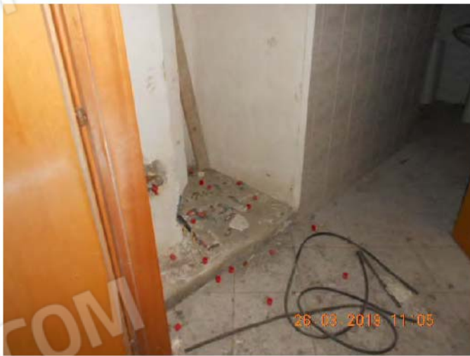
Wc 4: vandalizzato centralina impianti sanitari.
