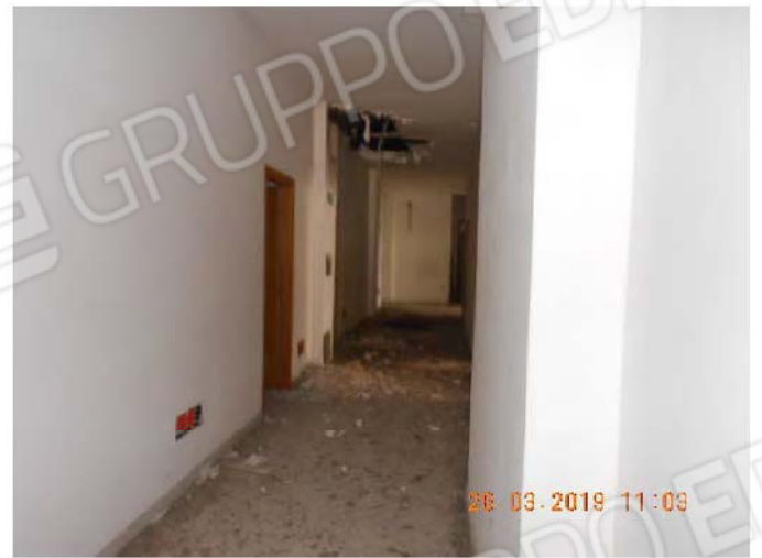
Disimpegno 2: controsoffitto crollato.
