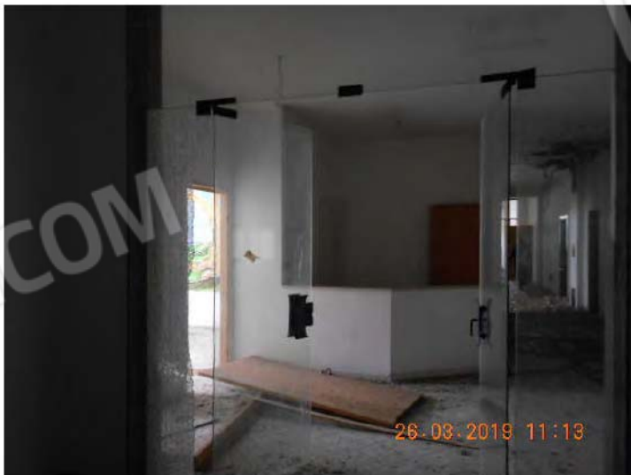
Ingresso con vetrata vandalizzata.
