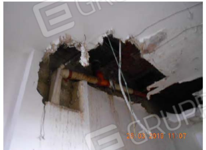
Vista del controsoffitto crollato nel disimpegno 2.
