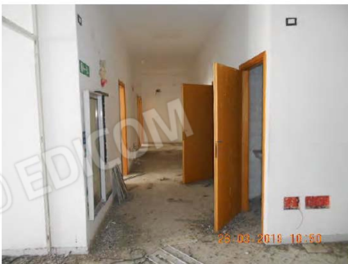
Disimpegno 1: da notare la vandalizzazione.
