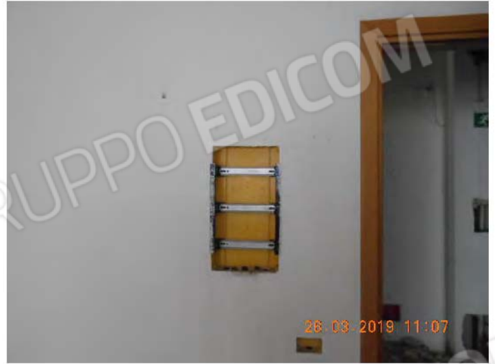
Quadretto dismesso ubicato nel Vano 9.
