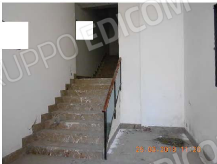
Vano scala: a terra si trovano fili elettrici dismessi.
