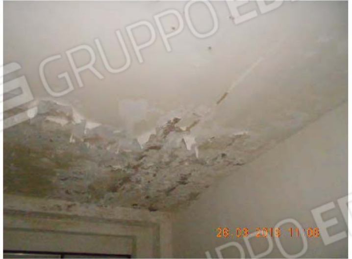
Soffitto Vano 6: perdita proveniente dal piano superiore.
