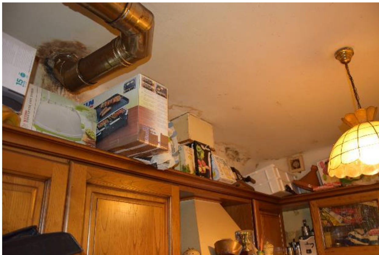
FOTO 33 locale 1 (utilizzato come cucina) particolare delle infiltrazioni dalla copertura in corrispondenza del camino di esalazione della stufa
