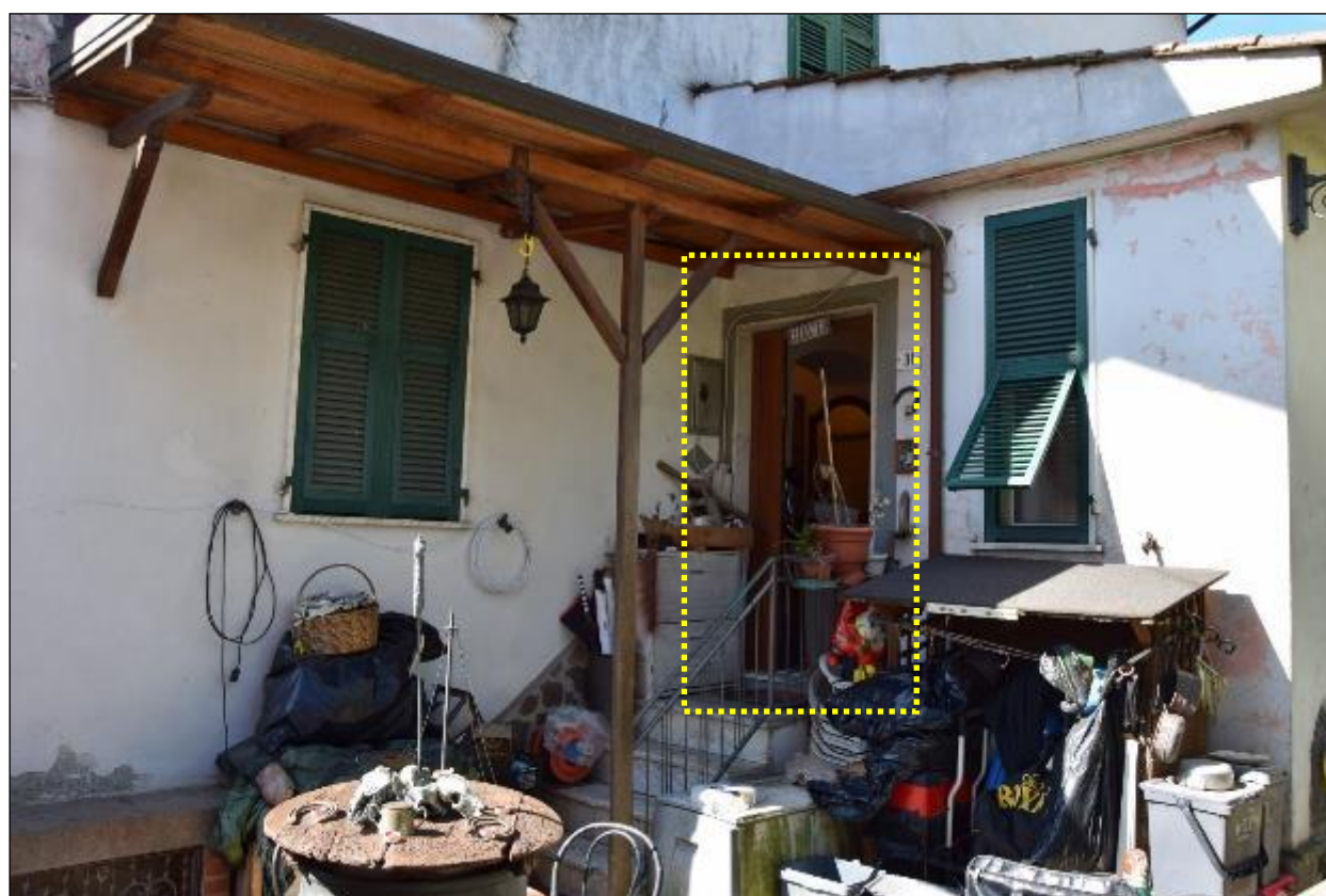
FOTO 14 – INGRESSO APPARTAMENTO – SUB. 8 tettoia-portico su mapp. 258 (corte)
