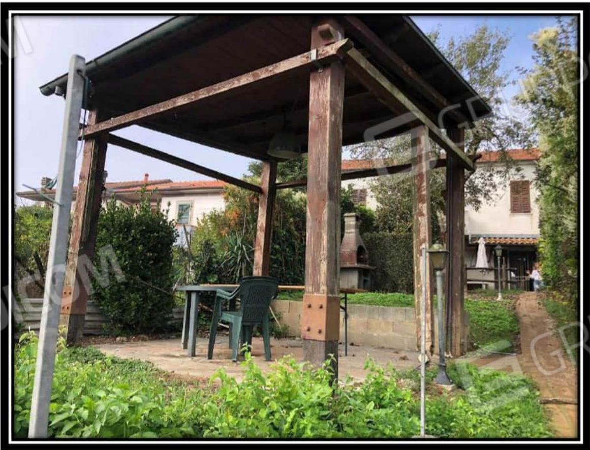
Foto 29 – Terrreno mappale 902 – Tettoia
