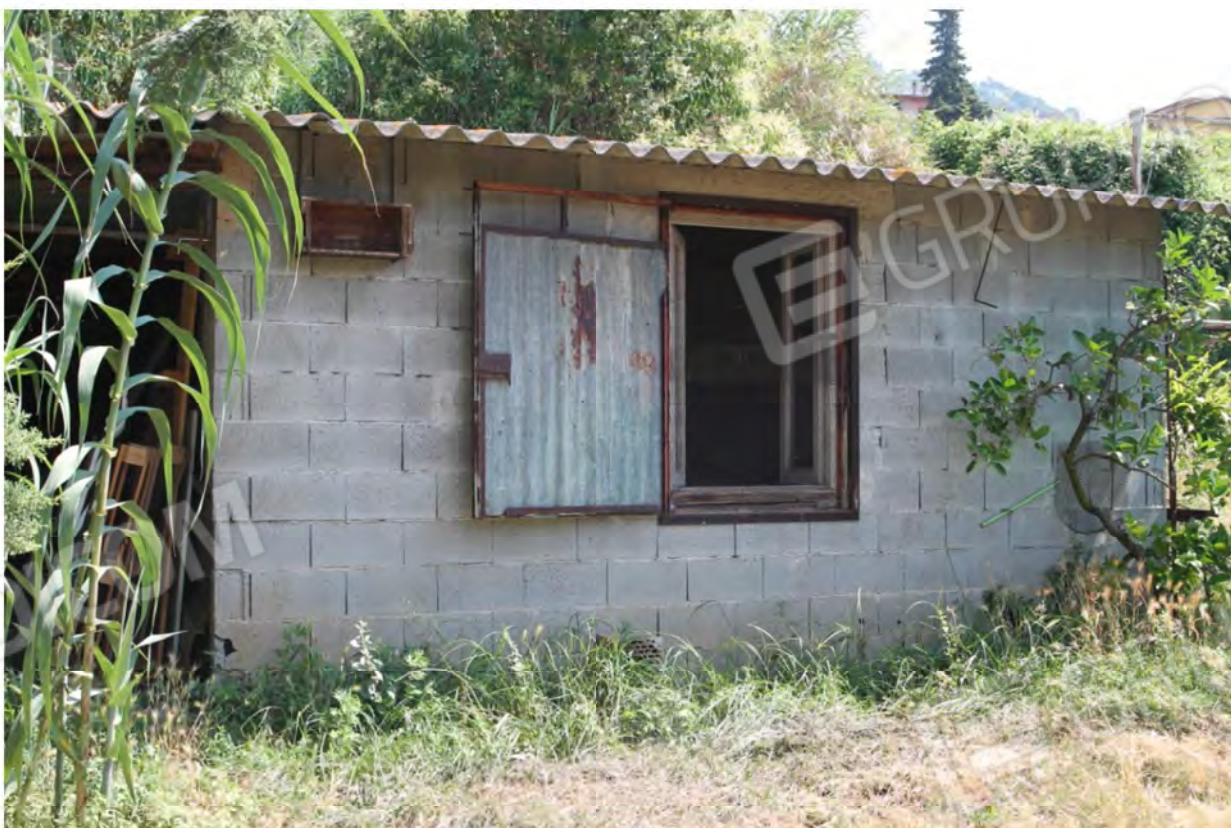
Foto 66. Manufatto abusivo realizzato all'interno del Fg. 63 Mapp. 889
