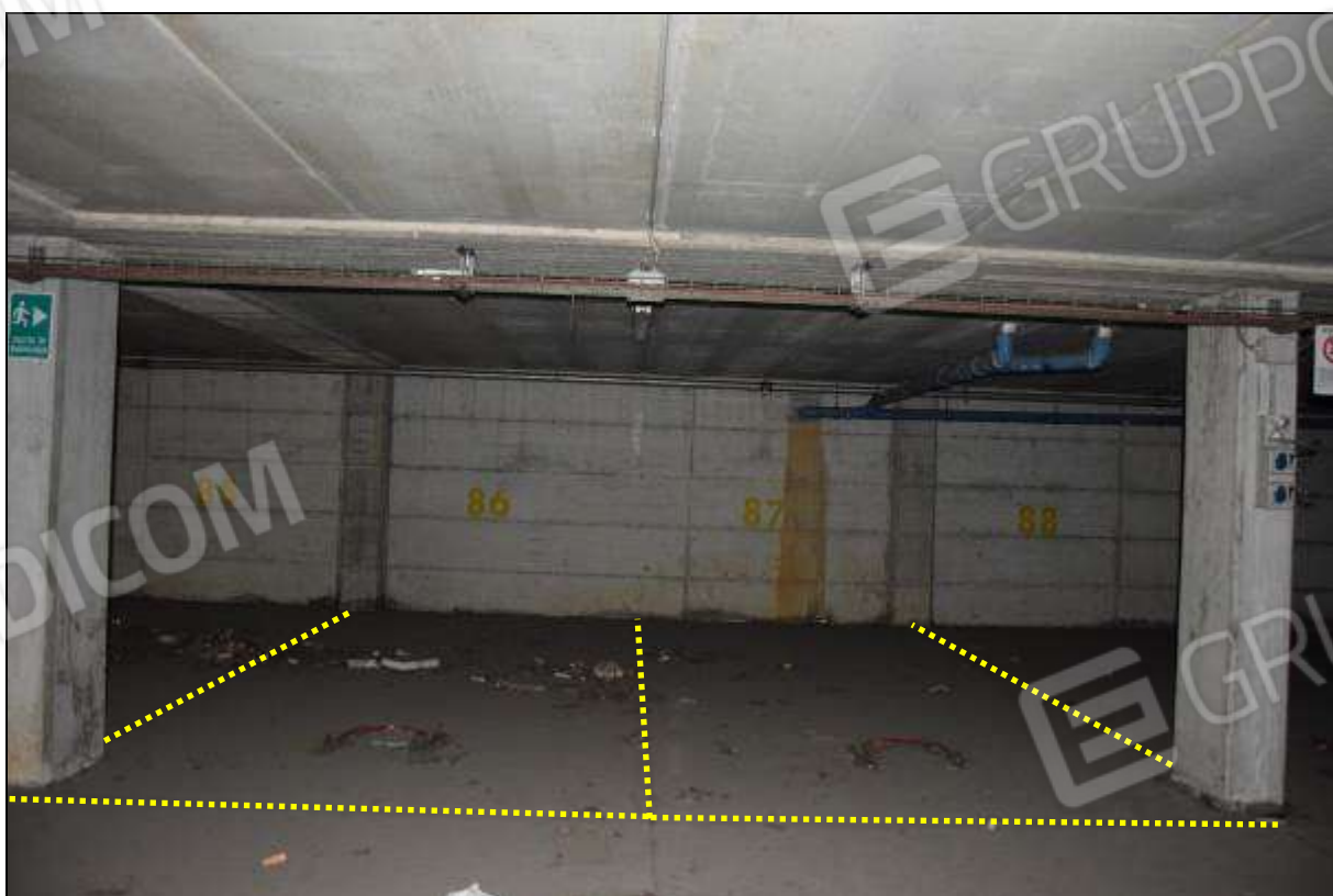
FOTO 4 – SUB 73 (POSTO 86) / SUB 74 (POSTO 87)
