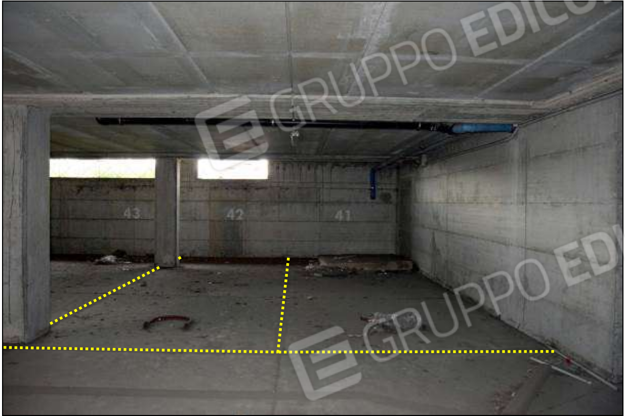
FOTO 1 – SUB 108 (POSTO 42) / SUB 109 (POSTO 41)
