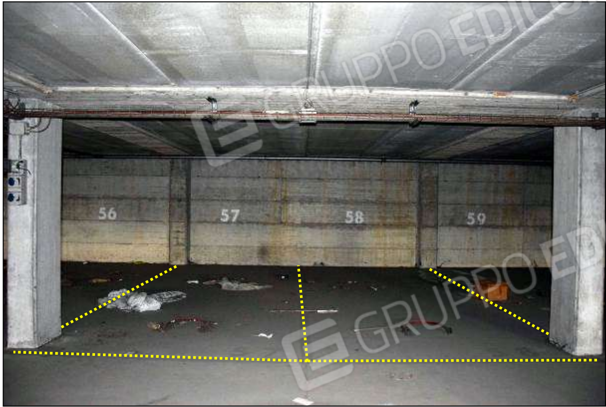
FOTO 1 – SUB 61 (POSTO 57) / SUB 62 (POSTO 58)
