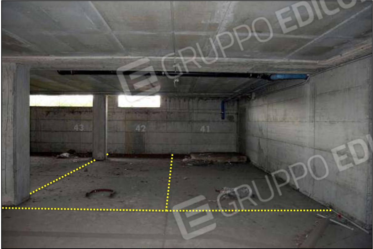
FOTO 1 – SUB 108 (POSTO 42) / SUB 109 (POSTO 41)
