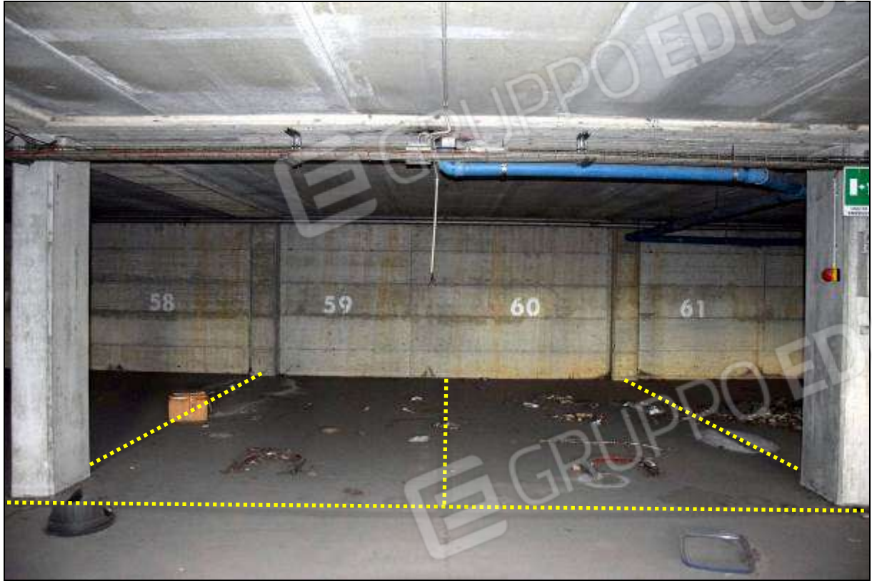
FOTO 1 – SUB 63 (POSTO 59) / SUB 64 (POSTO 60)
