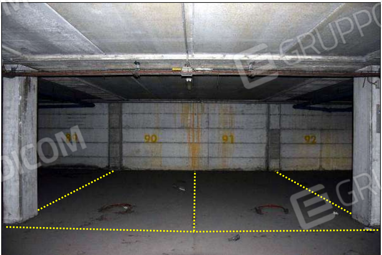
FOTO 6 – SUB 77 (POSTO 90) / SUB 78 (POSTO 91)
