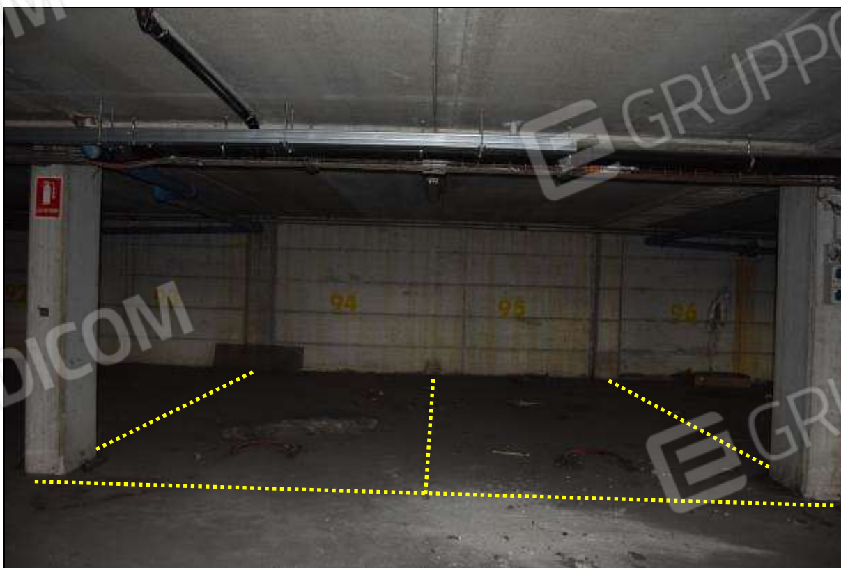
FOTO 8 – SUB 81 (POSTO 94) / SUB 82 (POSTO 95)
