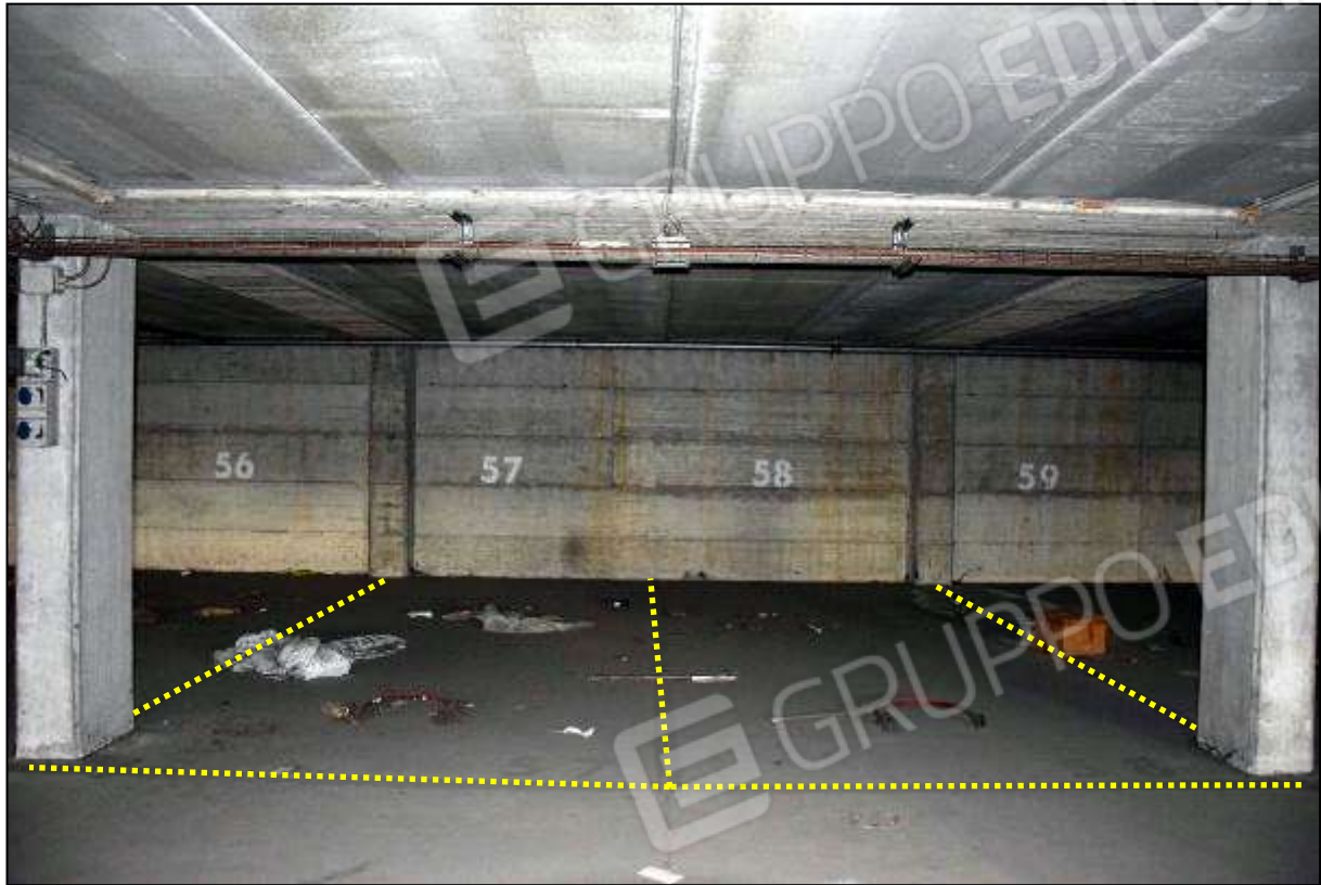
FOTO 1 – SUB 61 (POSTO 57) / SUB 62 (POSTO 58)
