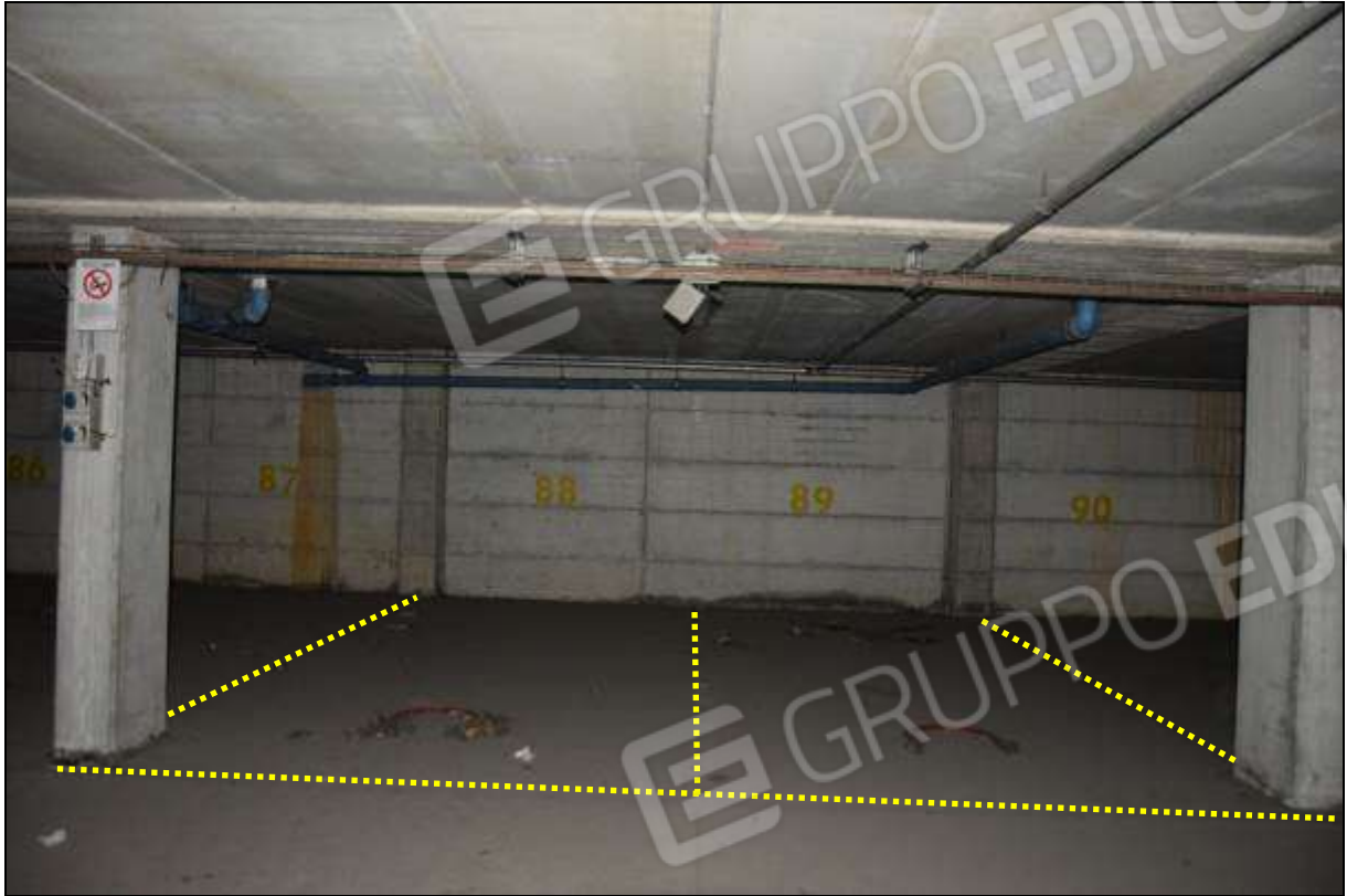
FOTO 5 – SUB 75 (POSTO 88) / SUB 76 (POSTO 89)
