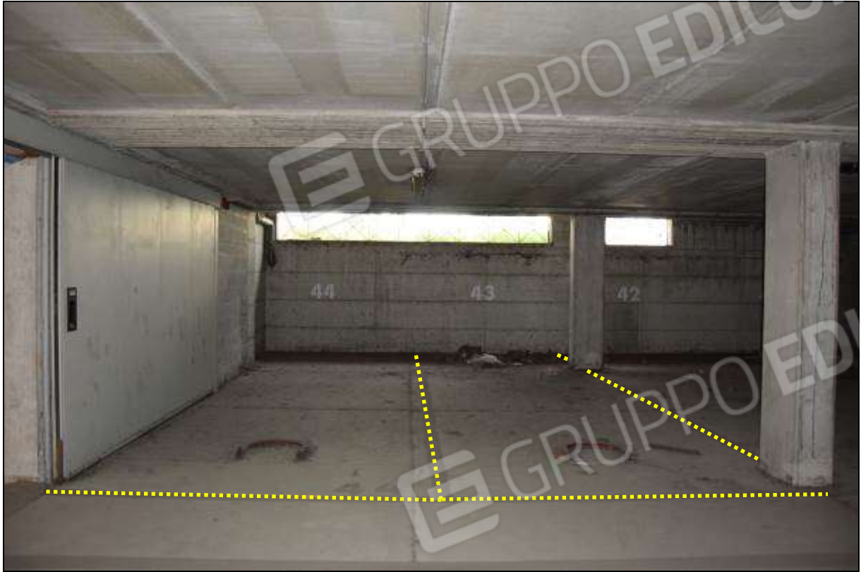
FOTO 1 – SUB 106 (POSTO 44) / SUB 107 (POSTO 43)
