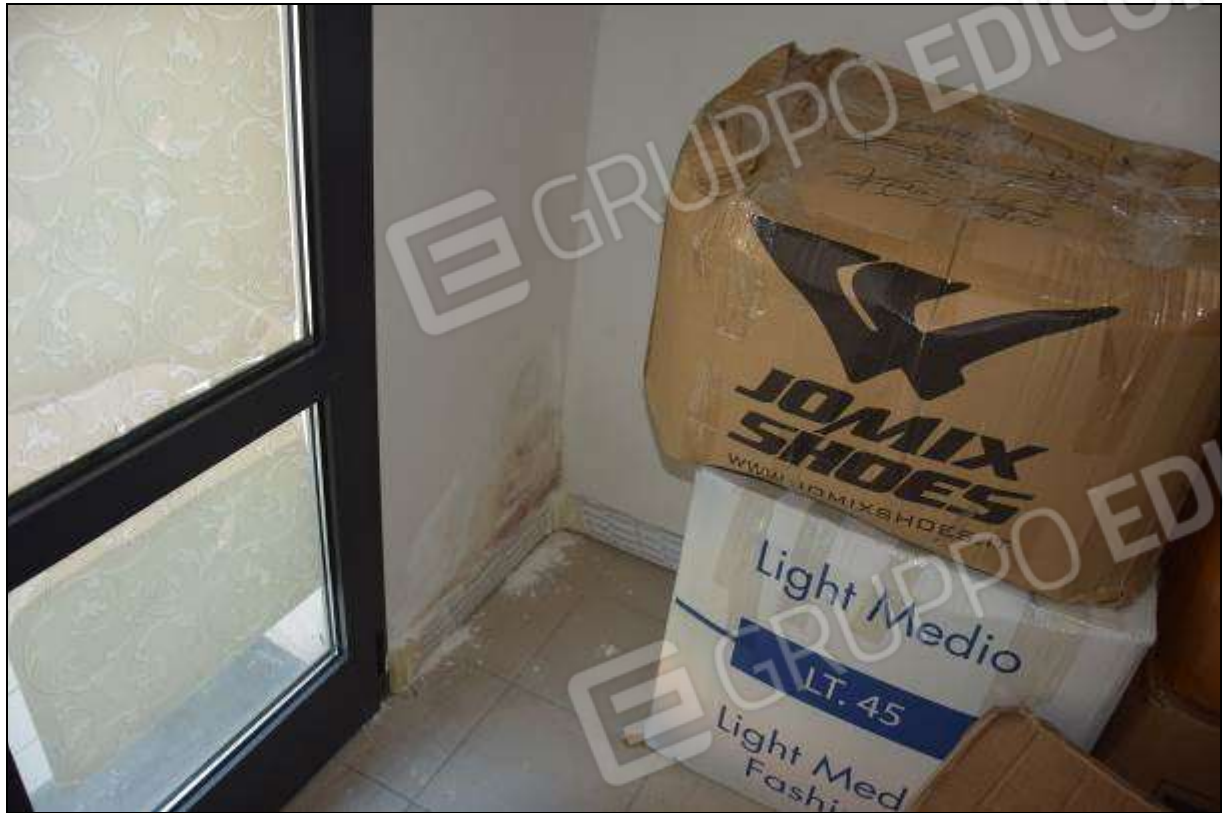
FOTO 13 – infiltrazione di umidità proveniente dalla terrazza
