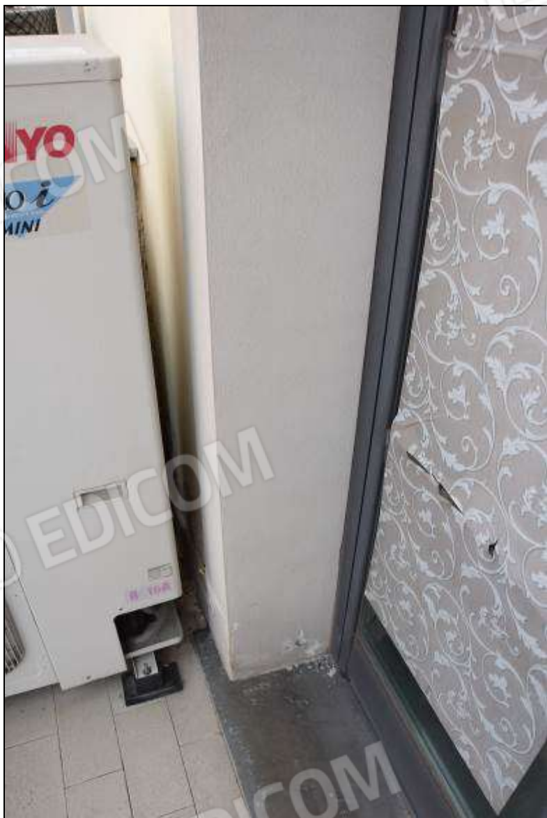
FOTO 11 – infiltrazione di umidità
