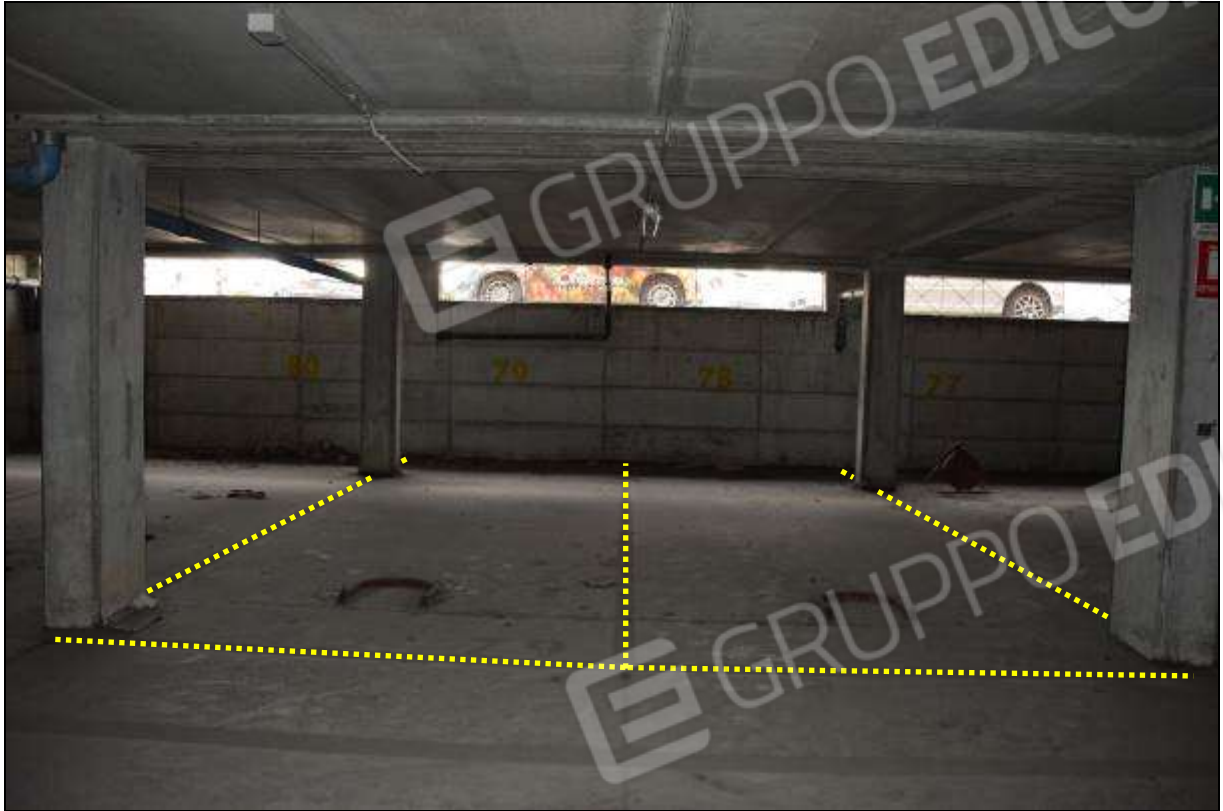
FOTO 1 – SUB 89 (POSTO 79) / SUB 90 (POSTO 78)
