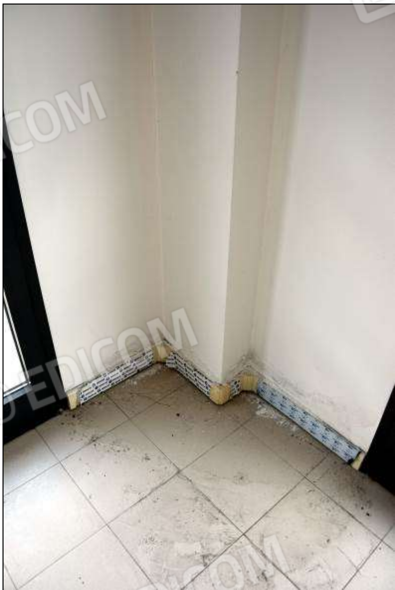
FOTO 11 – infiltrazioni di umidità
