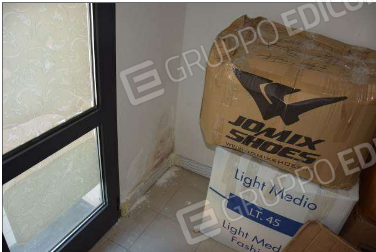
FOTO 13 – infiltrazione di umidità proveniente dalla terrazza
