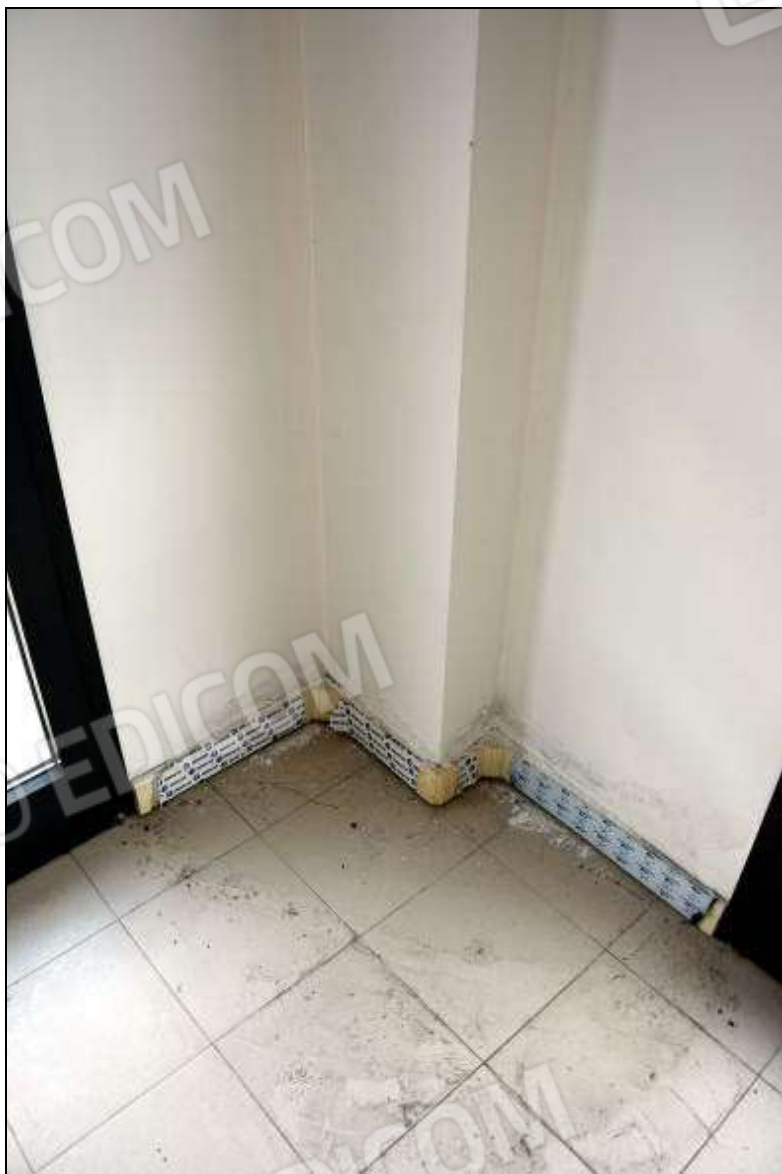
FOTO 11 – infiltrazioni di umidità
