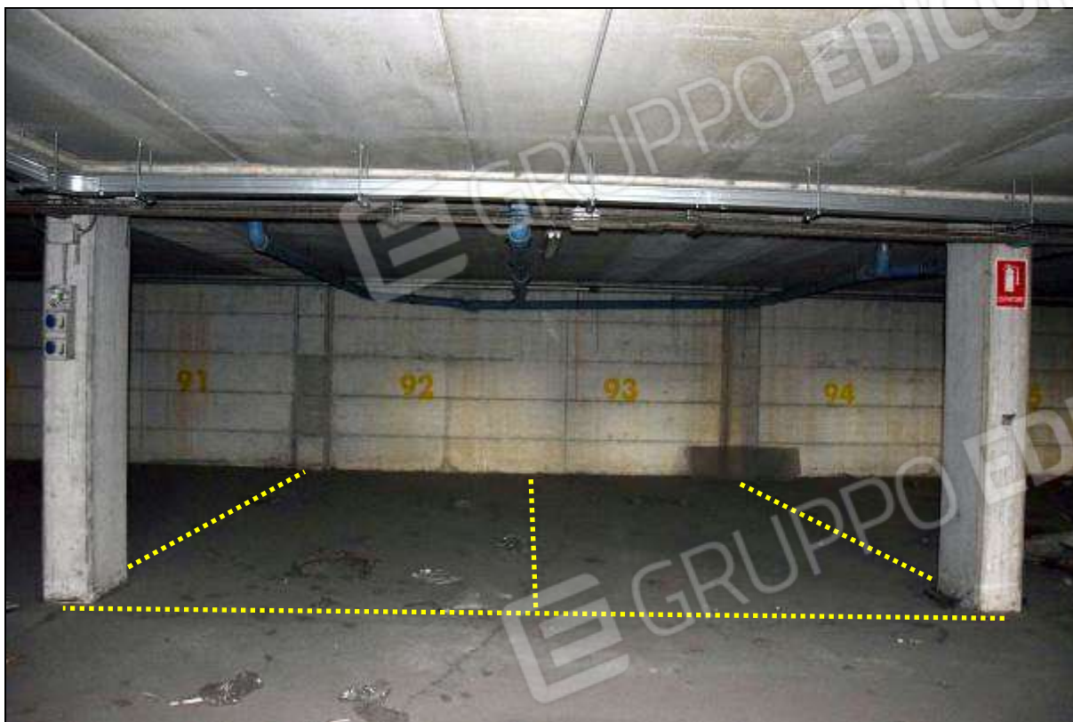
FOTO 7 – SUB 79 (POSTO 92) / SUB 80 (POSTO 93)
