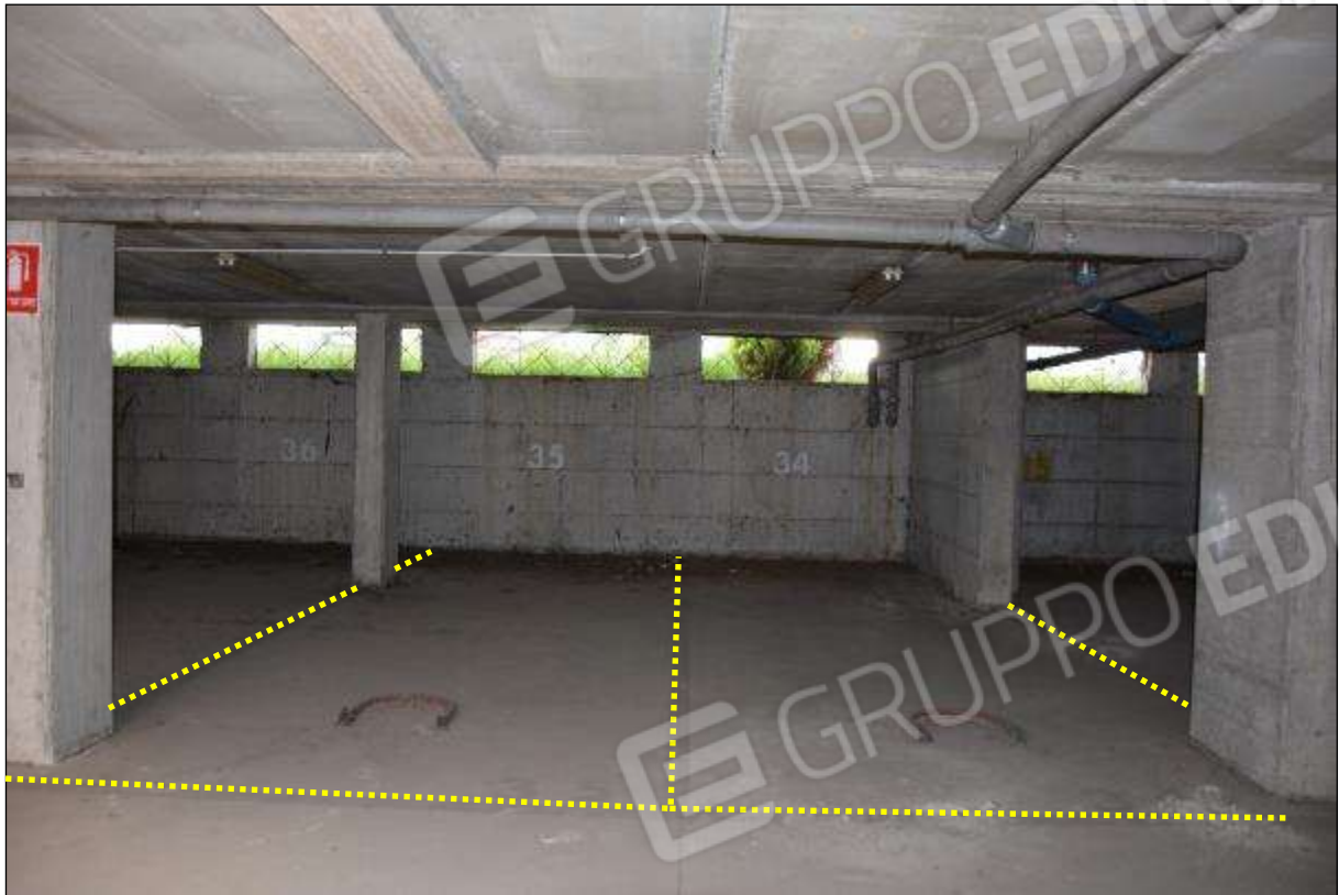
FOTO 3 – SUB 115 (POSTO 35) – SUB 116 (POSTO 34)
