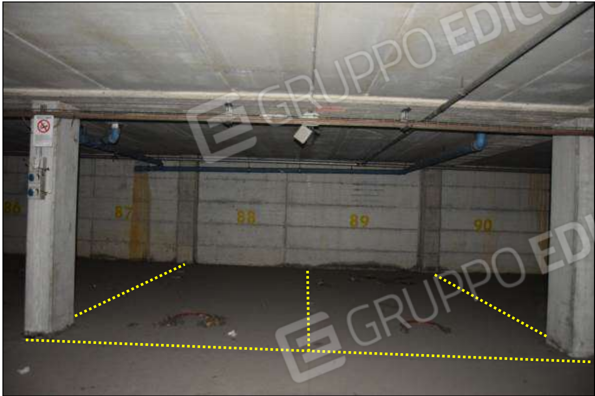
FOTO 5 – SUB 75 (POSTO 88) / SUB 76 (POSTO 89)
