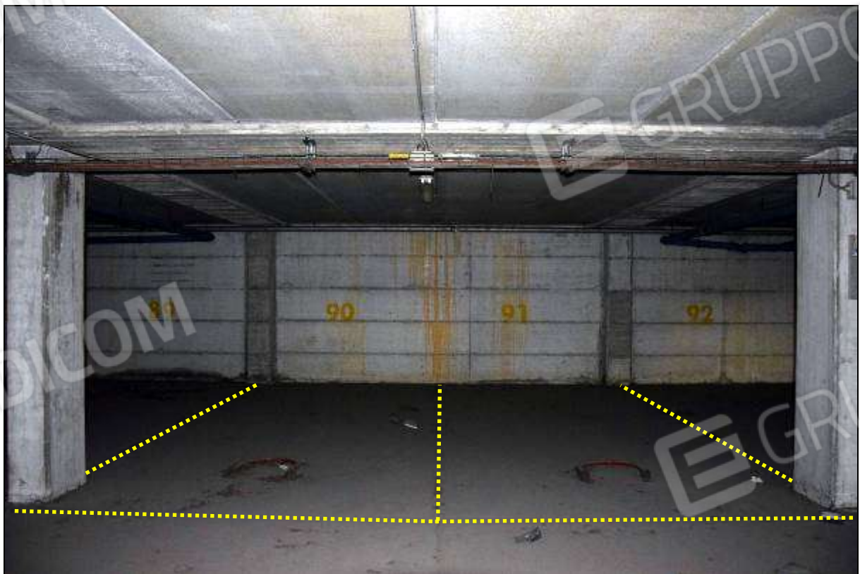
FOTO 6 – SUB 77 (POSTO 90) / SUB 78 (POSTO 91)
