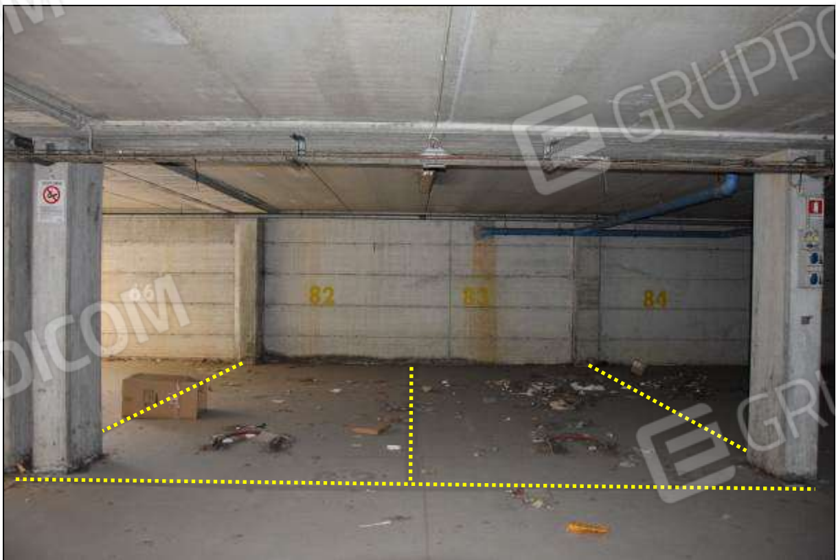
FOTO 2 – SUB 69 (POSTO 82) / SUB 70 (POSTO 83)
