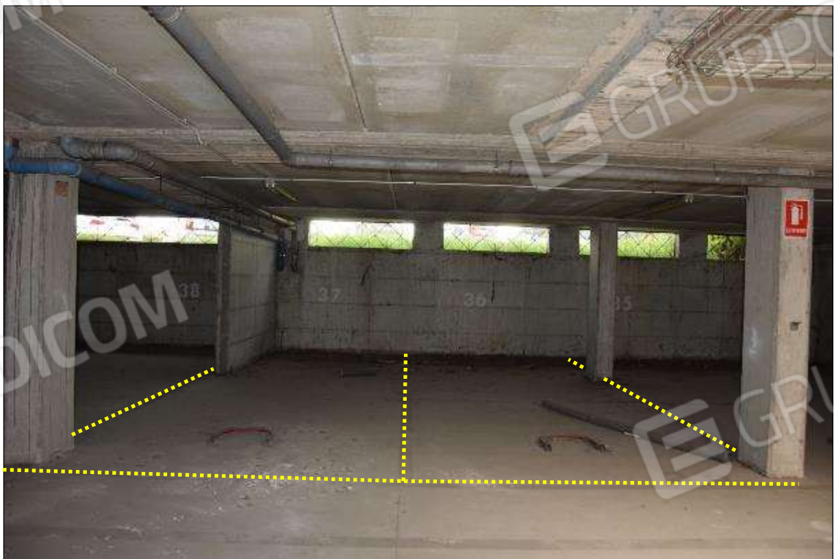
FOTO 2 – SUB 113 (POSTO 37) – SUB 114 (POSTO 36)
