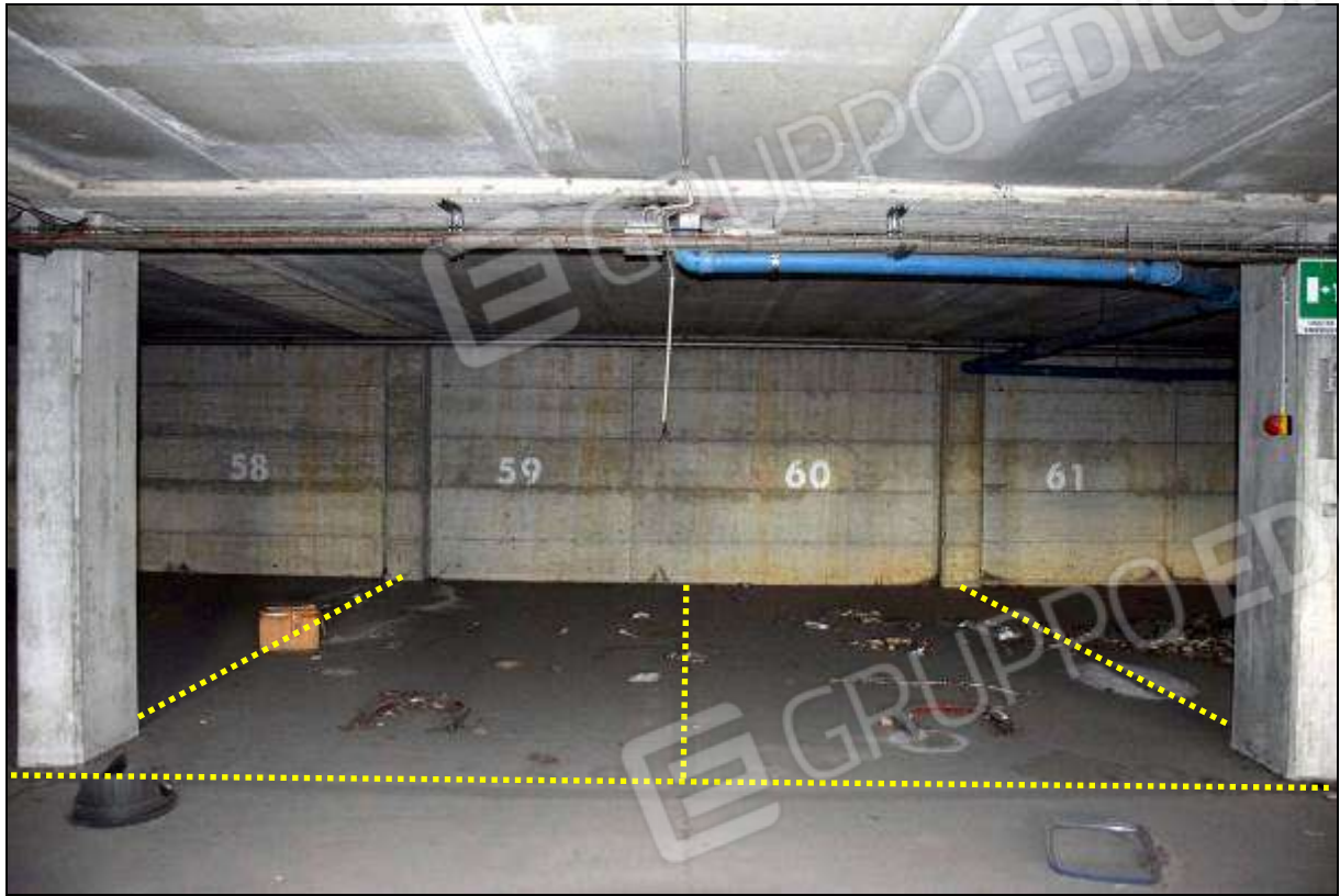
FOTO 1 – SUB 63 (POSTO 59) / SUB 64 (POSTO 60)
