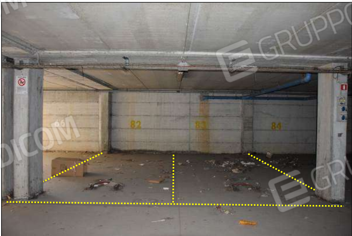
FOTO 2 – SUB 69 (POSTO 82) / SUB 70 (POSTO 83)
