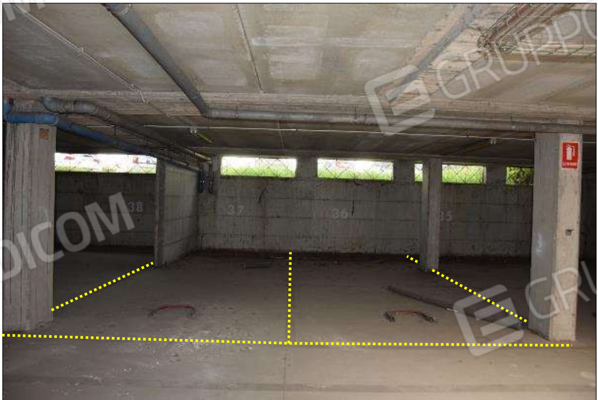
FOTO 2 – SUB 113 (POSTO 37) – SUB 114 (POSTO 36)
