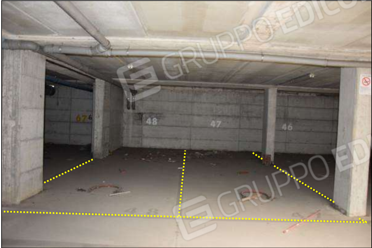
FOTO 1 – SUB 102 (POSTO 48) / SUB 103 (POSTO 47)
