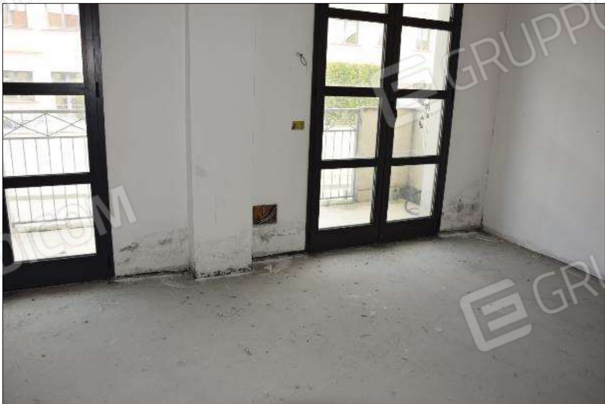
FOTO 84 – particolare - infiltrazioni d'acqua dalla terrazza
