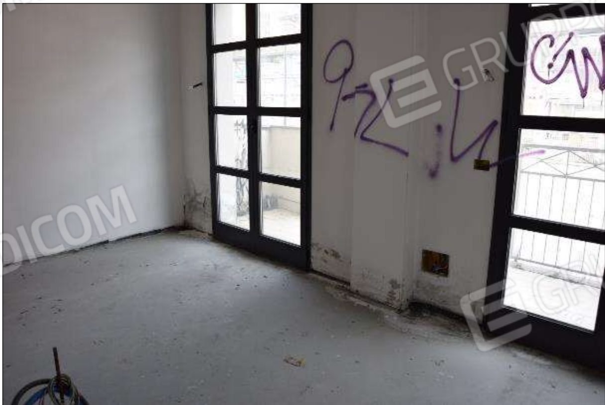
FOTO 78 – particolare - infiltrazioni d'acqua dalla terrazza
