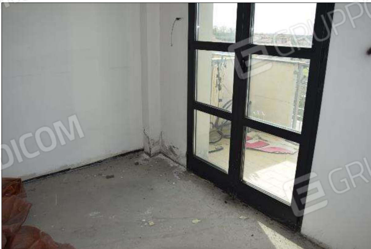
FOTO 44 - particolare - infiltrazioni d'acqua dalla terrazza
