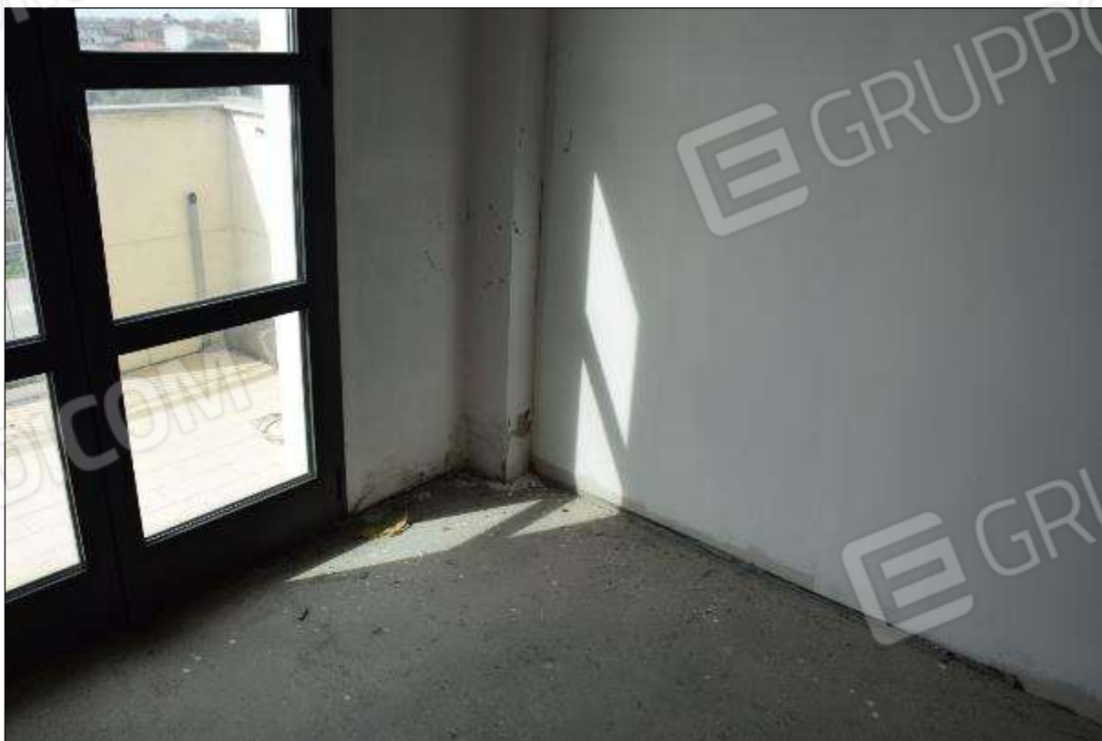
FOTO 38 – particolare - infiltrazioni d'acqua dalla terrazza
