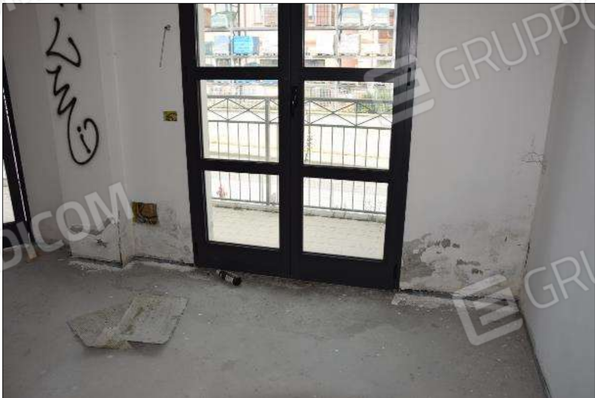
FOTO 72 – particolare - infiltrazioni d'acqua dalla terrazza
