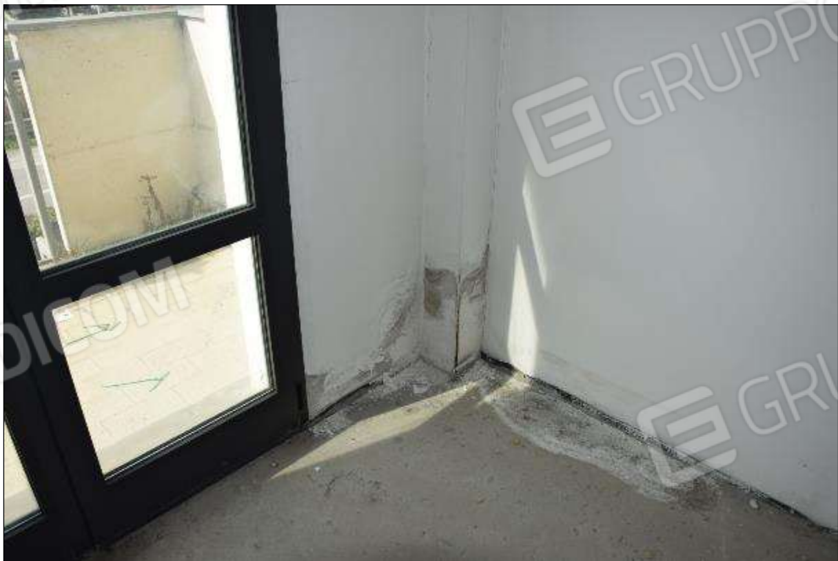
FOTO 12 – particolare - infiltrazioni d'acqua dalla terrazza
