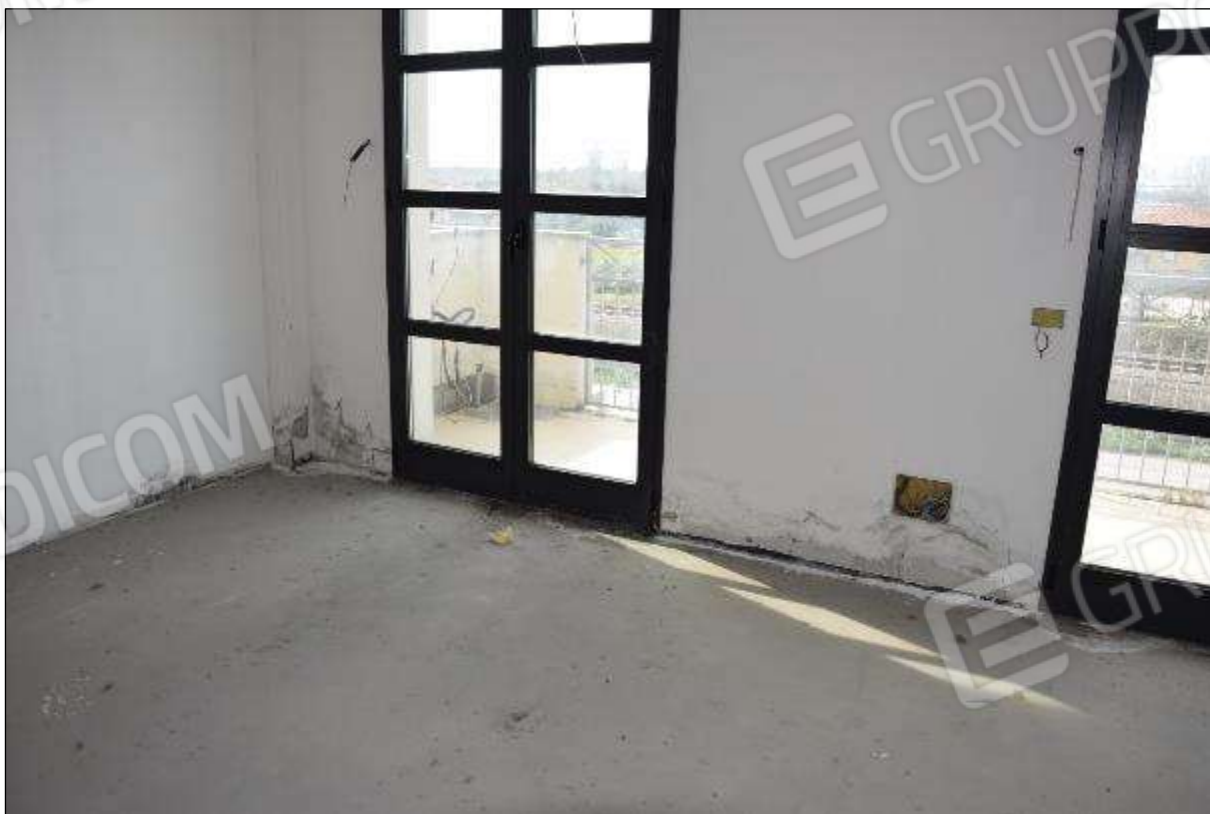
FOTO 18 – particolare - infiltrazioni d'acqua dalla terrazza
