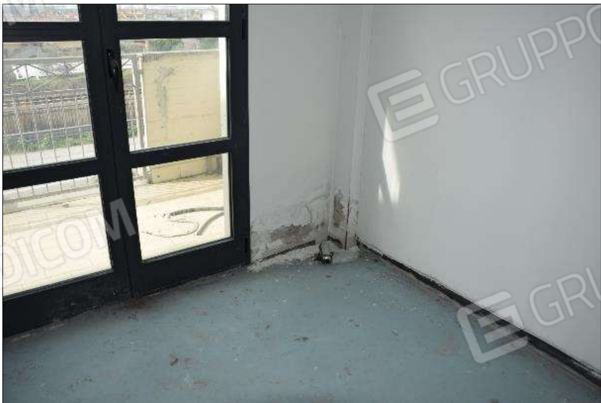
FOTO 24 – particolare - infiltrazioni d'acqua dalla terrazza
