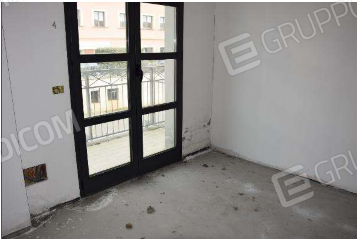
FOTO 90 – particolare - infiltrazioni d'acqua dalla terrazza
