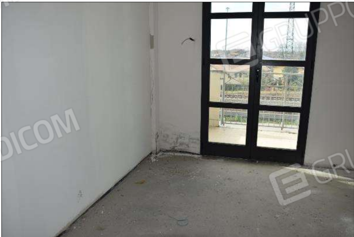
FOTO 31 – particolare - infiltrazioni d'acqua dalla terrazza
