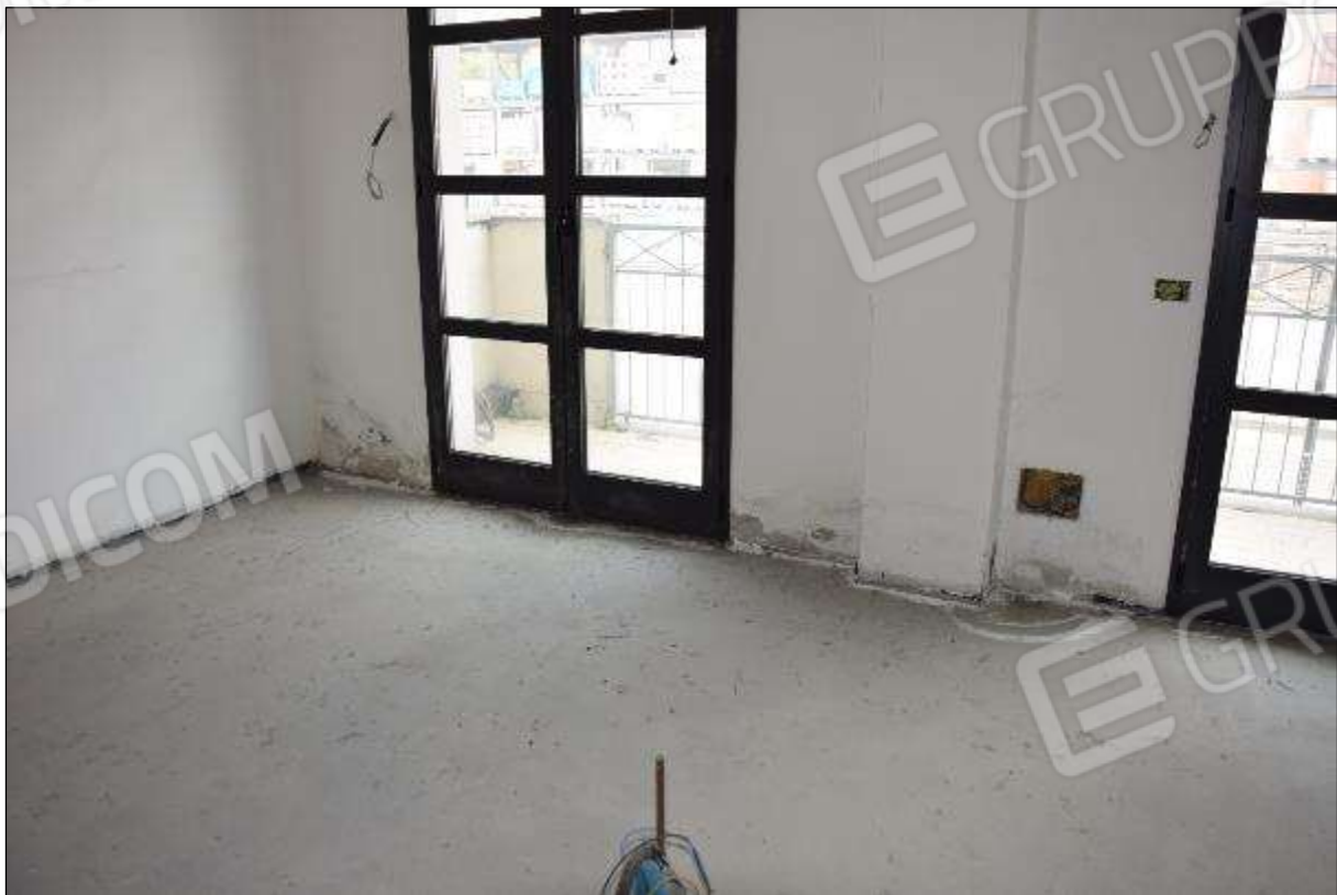
FOTO 66 – particolare - infiltrazioni d'acqua dalla terrazza
