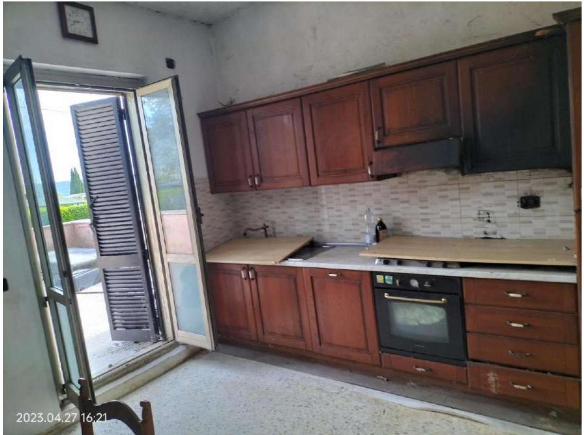
interno - cucina (particolare del danneggiamento in seguito ad un principio di incendio)
