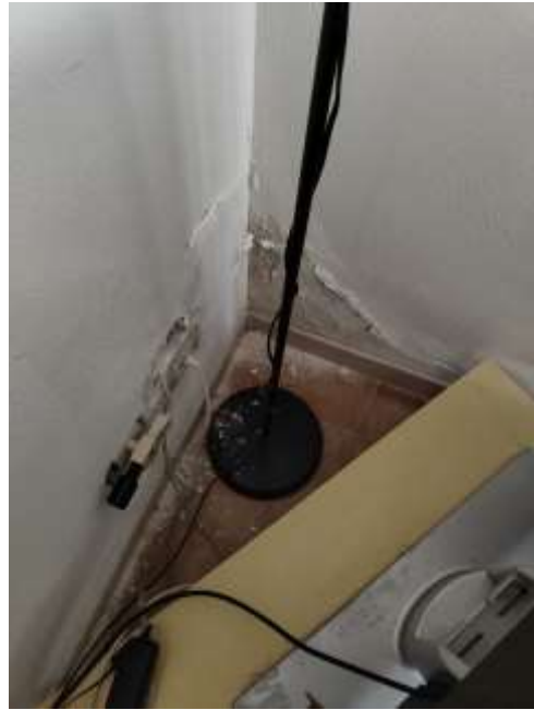
Vista problematiche umidità di risalita piano S1
