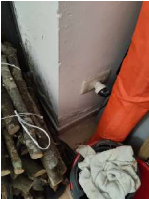
Vista problematiche umidità di risalita piano S1
