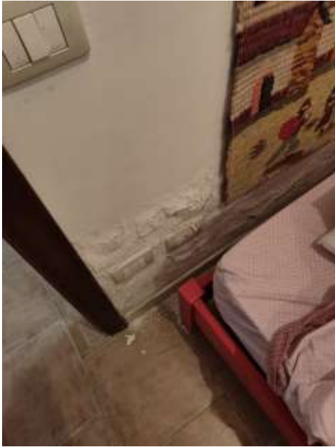
Vista problematiche umidità di risalita piano S1
