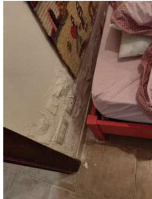
Vista problematiche umidità di risalita piano S1
