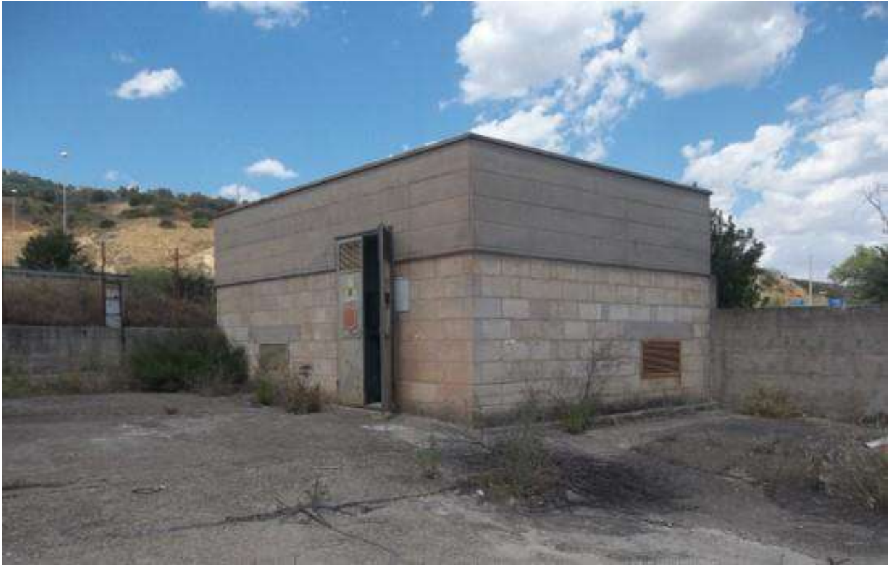
Foto 1 – Piano Terra – Quadro Elettrico e Cabina Enel – sub 2
