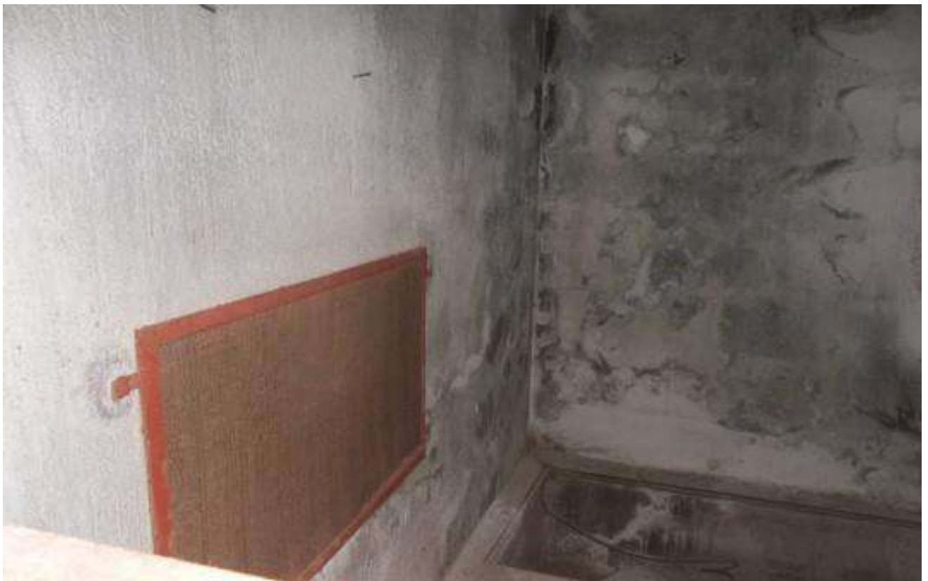
Foto 4 – Piano Terra – Cabina Enel – sub 2
