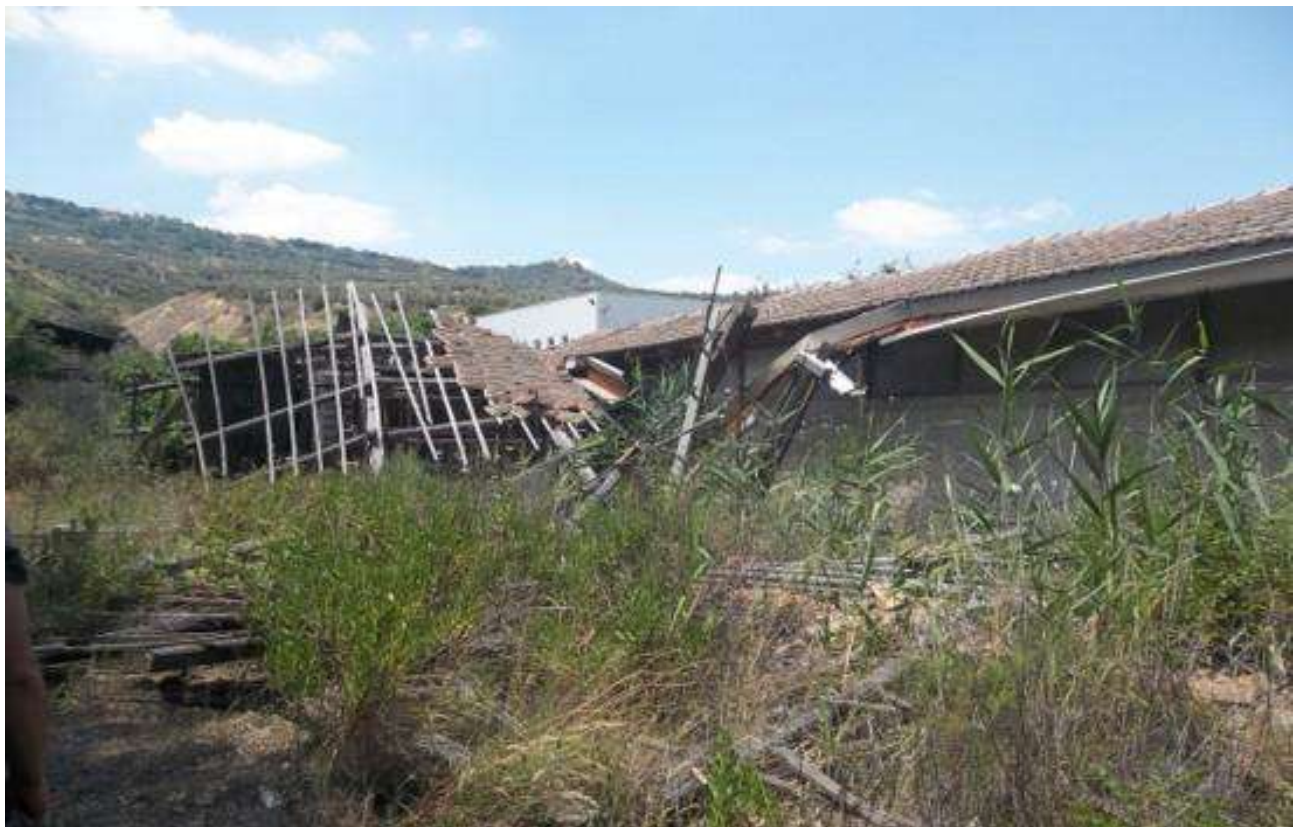
Foto 12 - Piano Terra – tettoia crollata – sub 5
