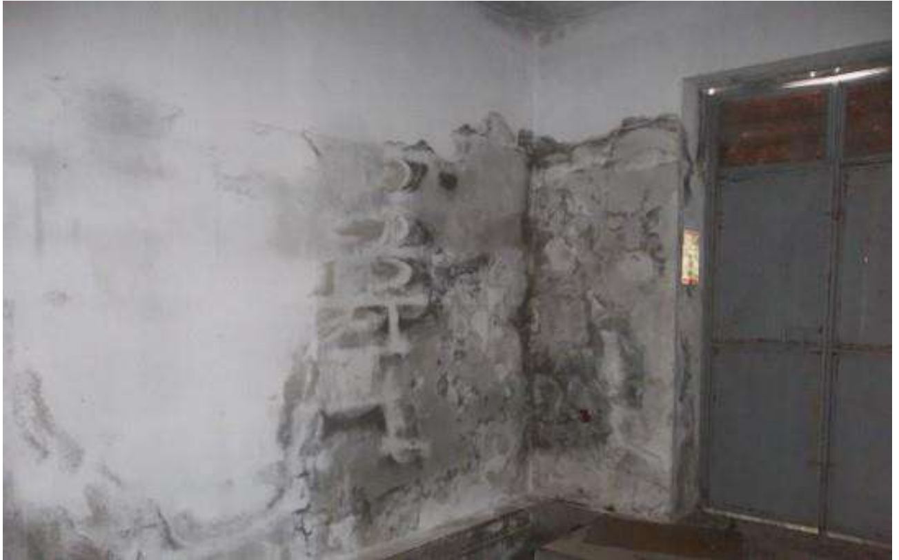
Foto 3 – Piano Terra – Cabina Enel – sub 2
