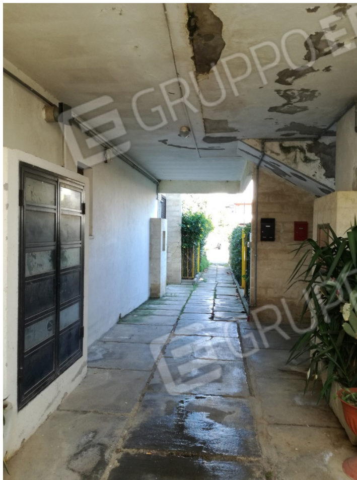
INGRESSO IMMOBILE CON INFILTRAZIONI DI ACQUA PIOVANA
