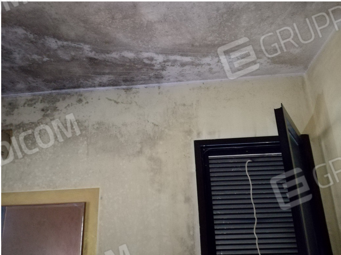
EVIDENTI SEGNI DI UMIDITA' NELLA CAMERA MATRIMONIALE
