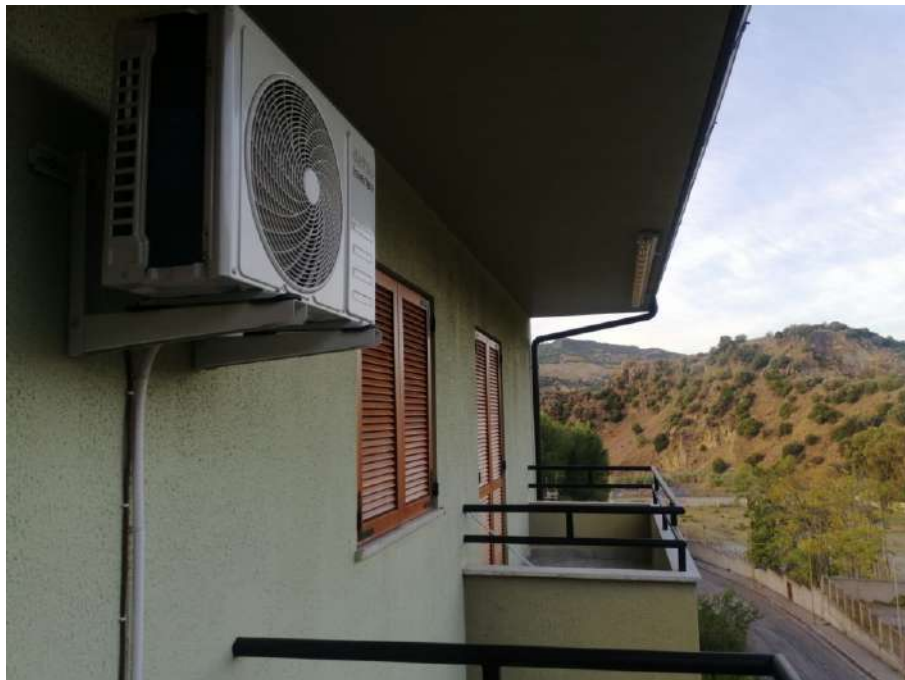
Foto n. 4 – particolare balcone su prospetto posteriore
