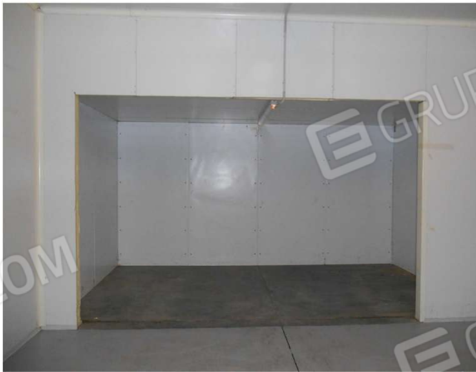
particolare 7: CELLA FRIGORIFERA.
