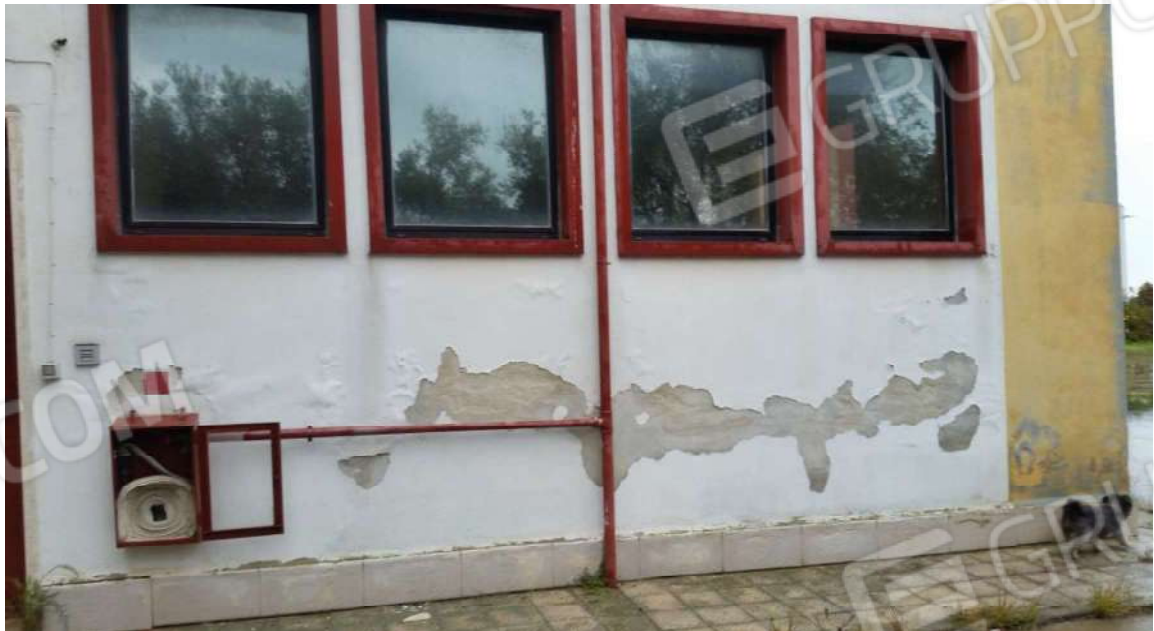
Foto 1-2-3: Degrado accentuato dei prospetti
