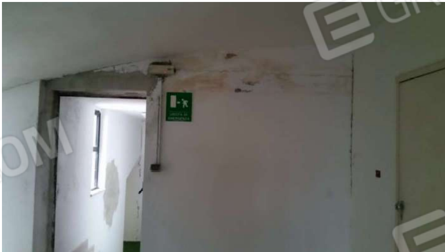
Foto 8-9: Infiltrazione acque meteoriche dalle coperture
