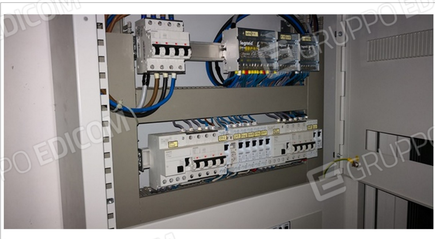
PARTICOLARE QUADRO ELETTRICO
