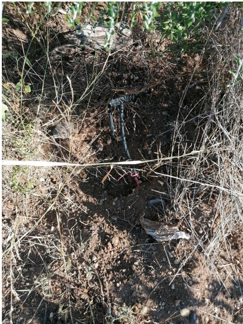
Foto 16 ( Particolare impianto irriguo sotterraneo tagliato – inservibile)
