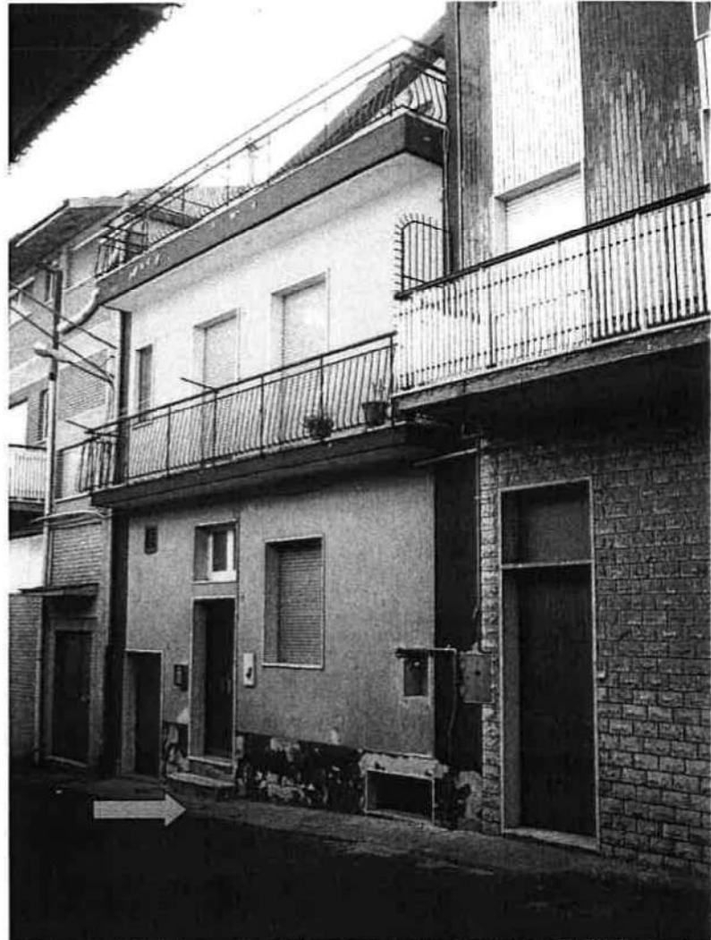
Foto n. 1 – Parte del prospetto anteriore con vista del marciapiede oggetto di intercapedine. Nella foto si notano i danni creati dalle infiltrazioni.
