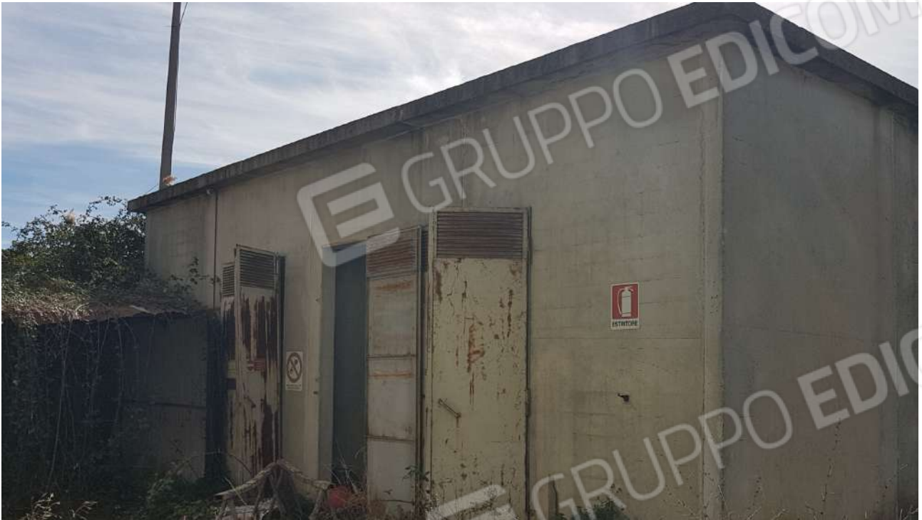
FOTO 5 vista della cabina elettrica (fg. 15-p.Ila 204-sub.3)
