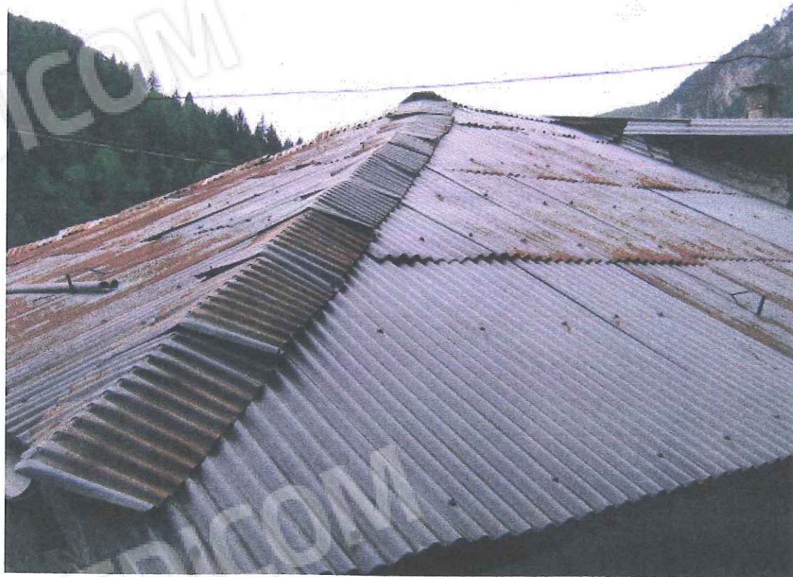
PARTICOLARE DEL MANTO DI COPERTURA DETERIORATO
