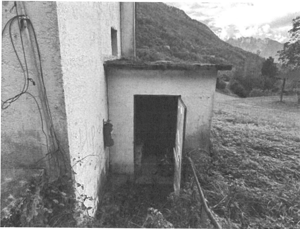
Foto 17: PS1 (sub. 3) centrale termica
