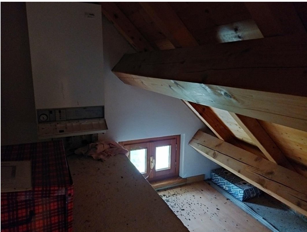
2P locale caldaia
