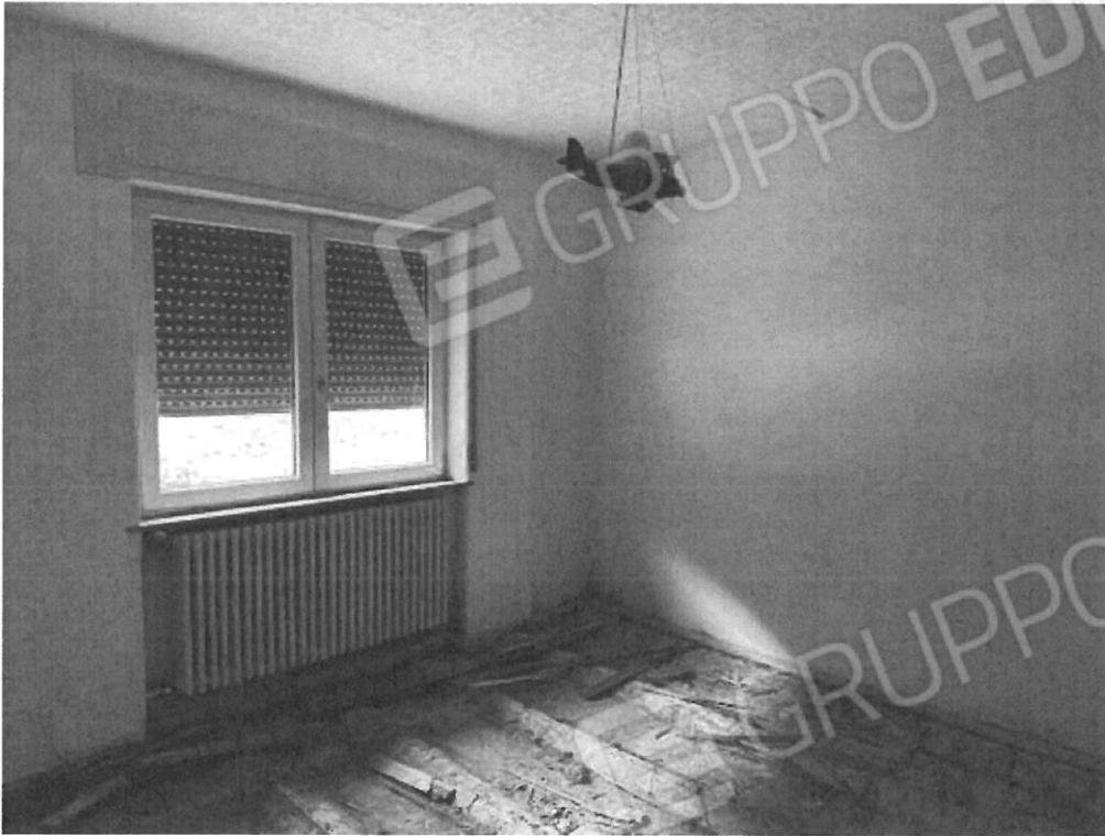
Foto 27: PT (sub. 3) camera angolo Sud
