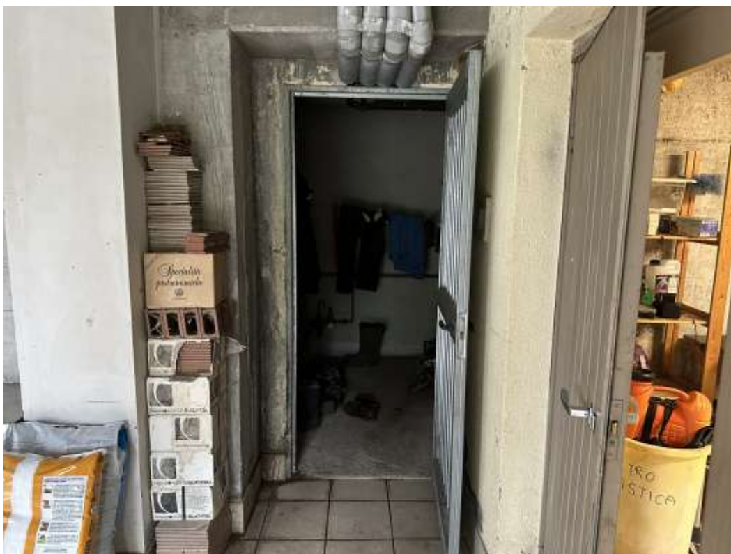
Foto 19: PS1 (sub. 3) centrale termica
