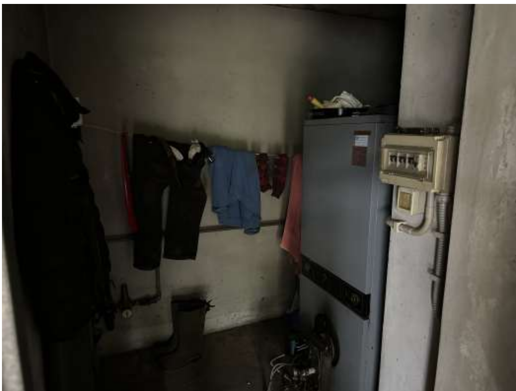
Foto 20: PS1 (sub. 3) centrale termica
