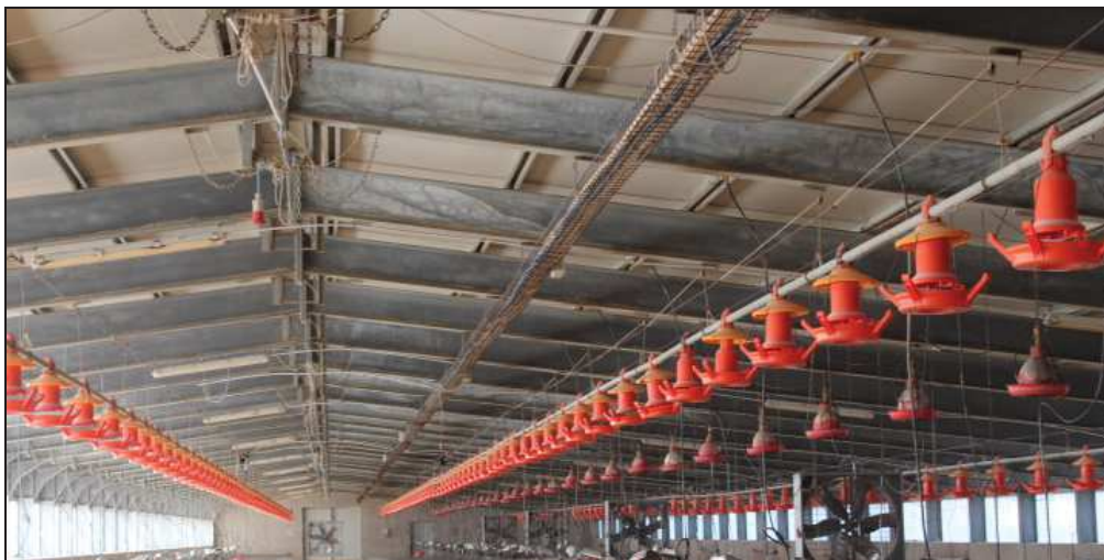
Figura 27 – controsoffitto del capannone 3 (in sandwich schiumato, rifatto nel 2004)
