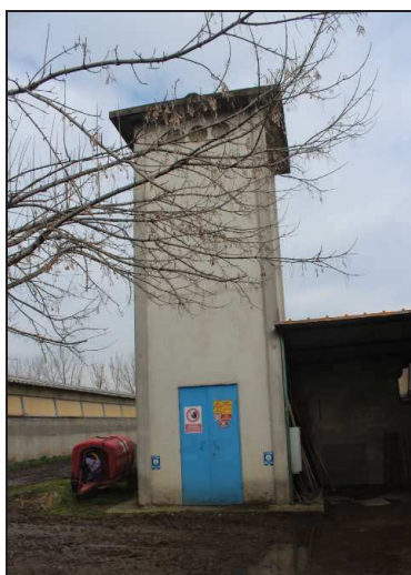
Figura 50 – Cabina ENEL (a sinistra il capannone n.2)
