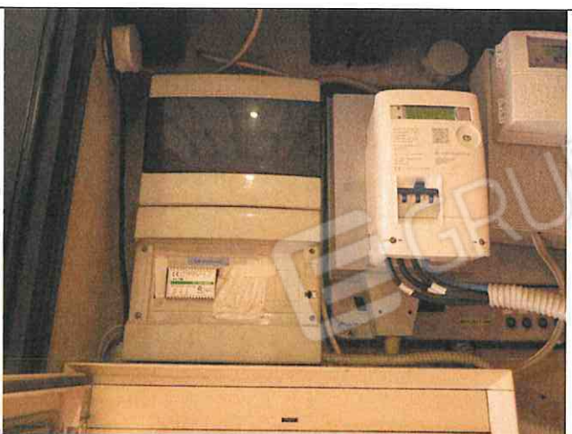
Foto n°82: contatori del ristorante
