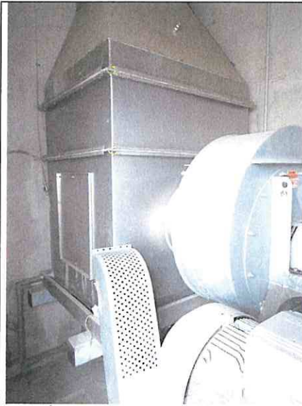
Foto n°99: Interno locale ventilatore
