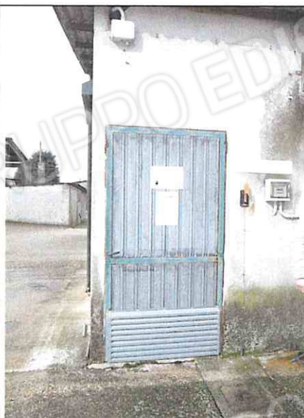
Foto n°71: Accesso alla C.T.
