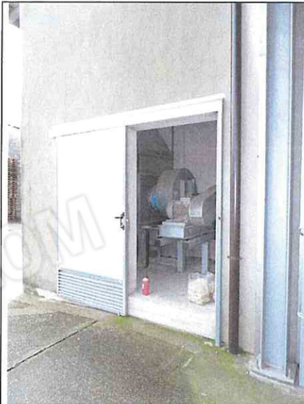
Foto n°101: Locale ventilatore ad est
