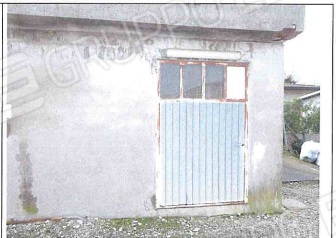
Foto n°90: Ingresso altro locale C.T.
