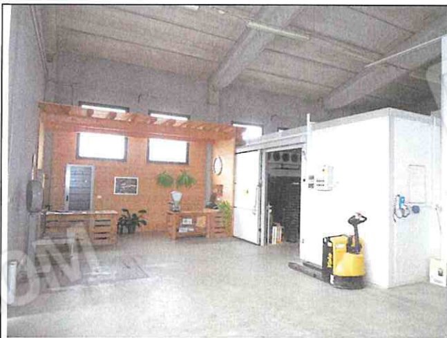
Foto n°130: Altra vista interno con cella frigo
