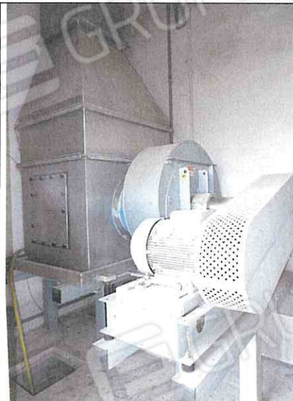
Foto n°102: Interno locale ventilatore
