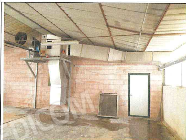
Foto n°56: Particolare impianto di trattamento aria
