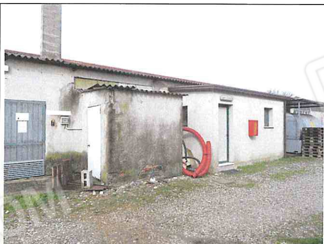
Foto n°42: Porzioni non coperte da regolare licenza
