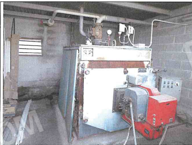
Foto n°89: Interno locale C.T.
