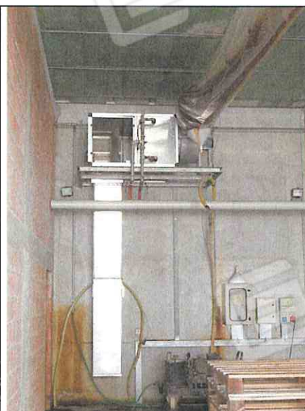
Foto n°151: Particolare impianto di aerazione
