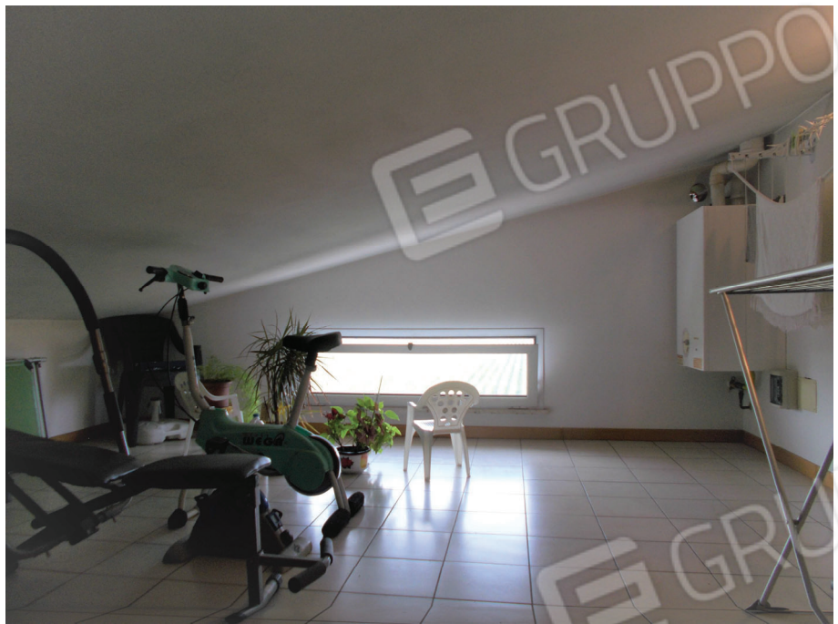
Foto 12- LOTTO 1- P.2.- Sottotetto, vano caldaia
