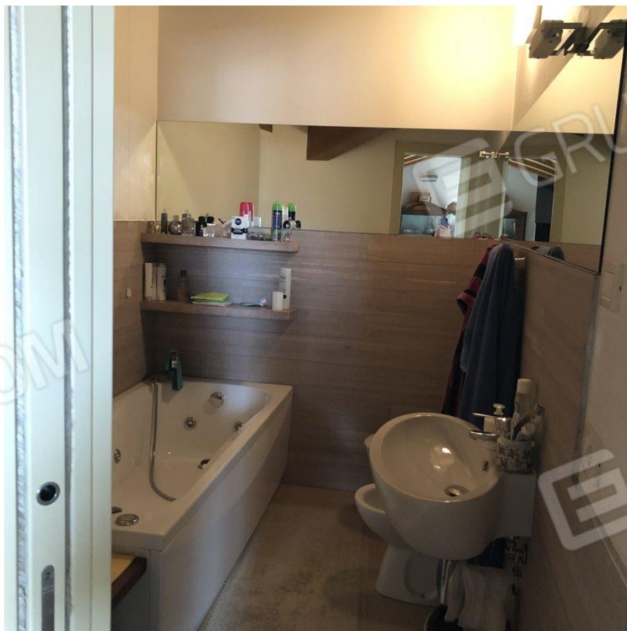
foto n. 22 – bagno abusivo al secondo piano
