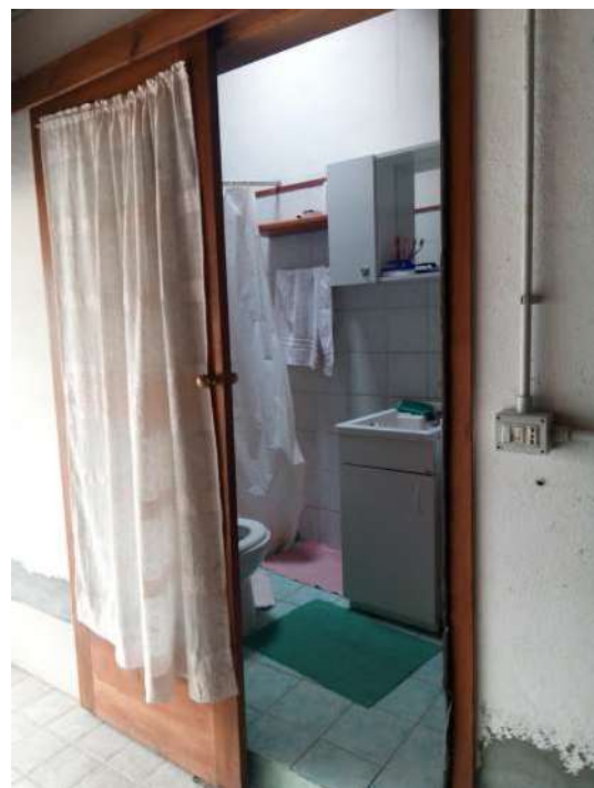
FOTO N. 18 Bagno interno garage
