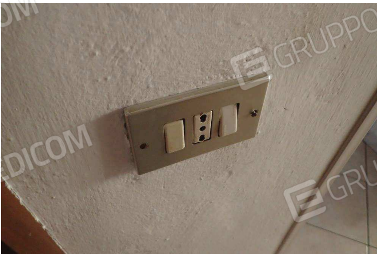
Foto 14 - Particolare impianto elettrico
