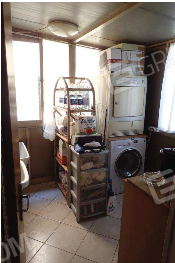
Foto 11 - Centrale Termica comune al LOTTO 2 utilizzata come lavanderia
