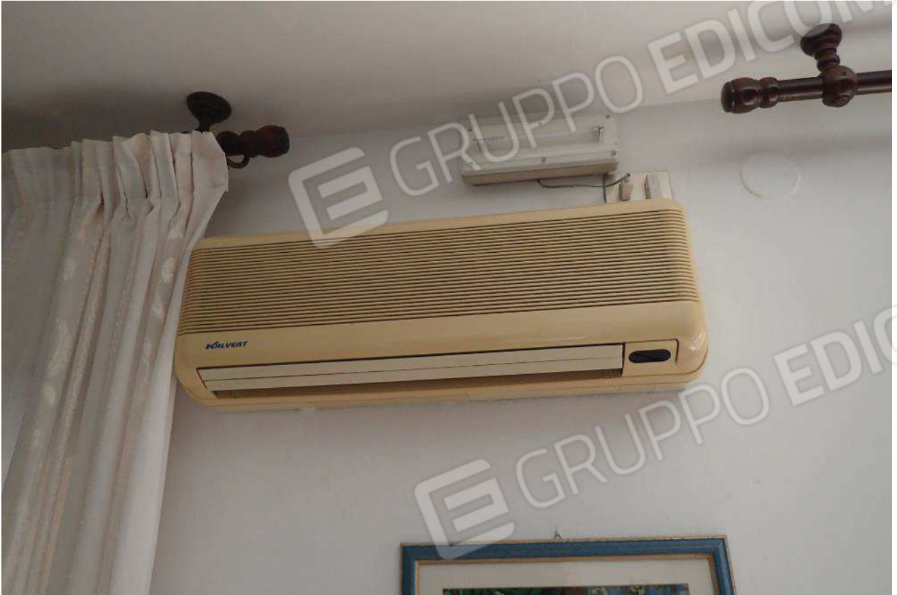
Foto 33 - Split impianto di condizionamento
