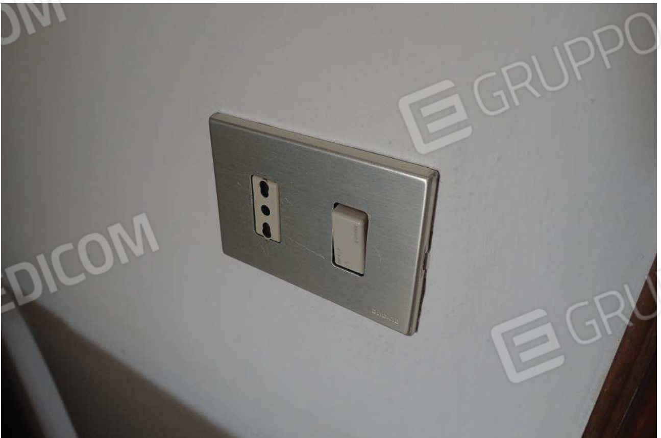
Foto 34 - Particolare impianto elettrico
