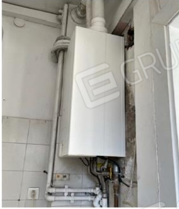
vista della caldaia
