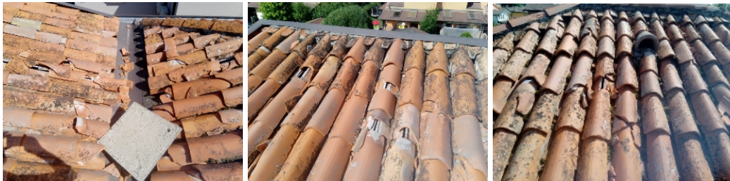
foto del tetto- danni al rivestimento in coppi
