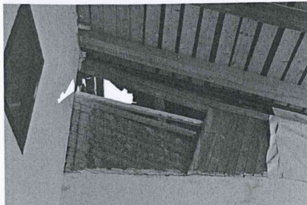
16 – Portico d'ingresso. Le infiltrazioni e i ristagni cui si faceva riferimento nella precedente didascalia provengono in larga misura da uno squarcio sulla copertura del contiguo m.n. 149, che stramazza nel porticato attraverso un vuoto nel muro di confine.
