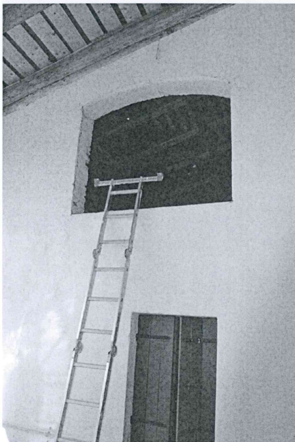
1 – Finestra d'accesso alla legnaia. L'apertura è praticabile solo servendosi di ausili provvisori da piazzare nel portico d'ingresso. Nel caso della visita peritale si è optato per una scala a pioli.
