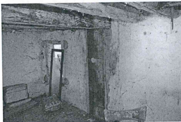
9 – Soffitta. Al locale si accede attraversando la breccia in foto n. 5. Il muro nord è interrotto a tutta altezza da una canna fumaria. Il locale ha altezza utile circa 1,85/1,90m.
