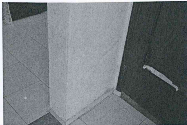
18 – Interno abitazione. Anche alla base di alcuni muri interni si vedono aloni di umidità d'apporto.
