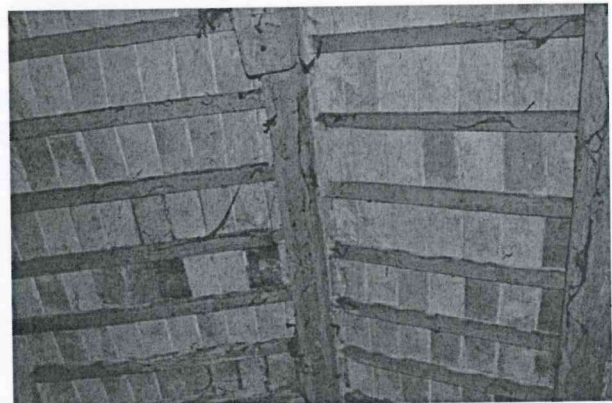
8 – Copertura del granaio. Dove il tetto superiore insiste sul locale catastalmente denominato "granaio", l'ordito abbandona il tavolato ad assi alterne e passa al laterizio tra un conventino e l'altro. Tra il pavimento della soffitta e il tetto in foto c'è lo stesso interpiano misurabile nell'attigua Legnaia, inframmezzato però dal solaio di cui alla foto n. 9.
