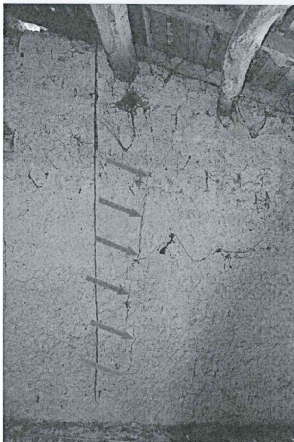
2 – Legnaia al primo piano. Il muro di spina che separa il locale dalla soffitta presenta una spaccatura verticale a tutto spessore di paramento (vedi frecce blu).
