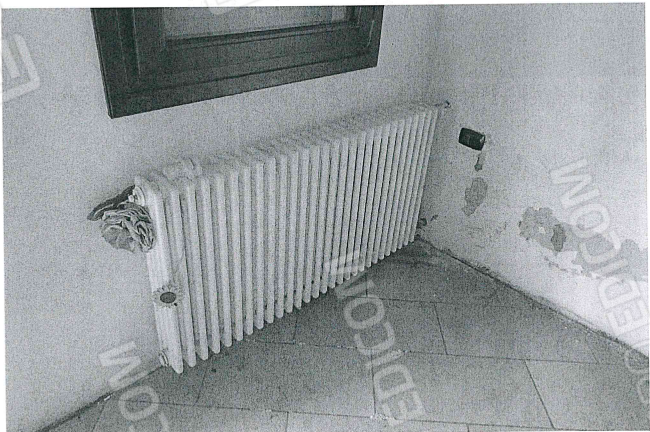
Foto 34 - Particolare impianto termoidraulico
