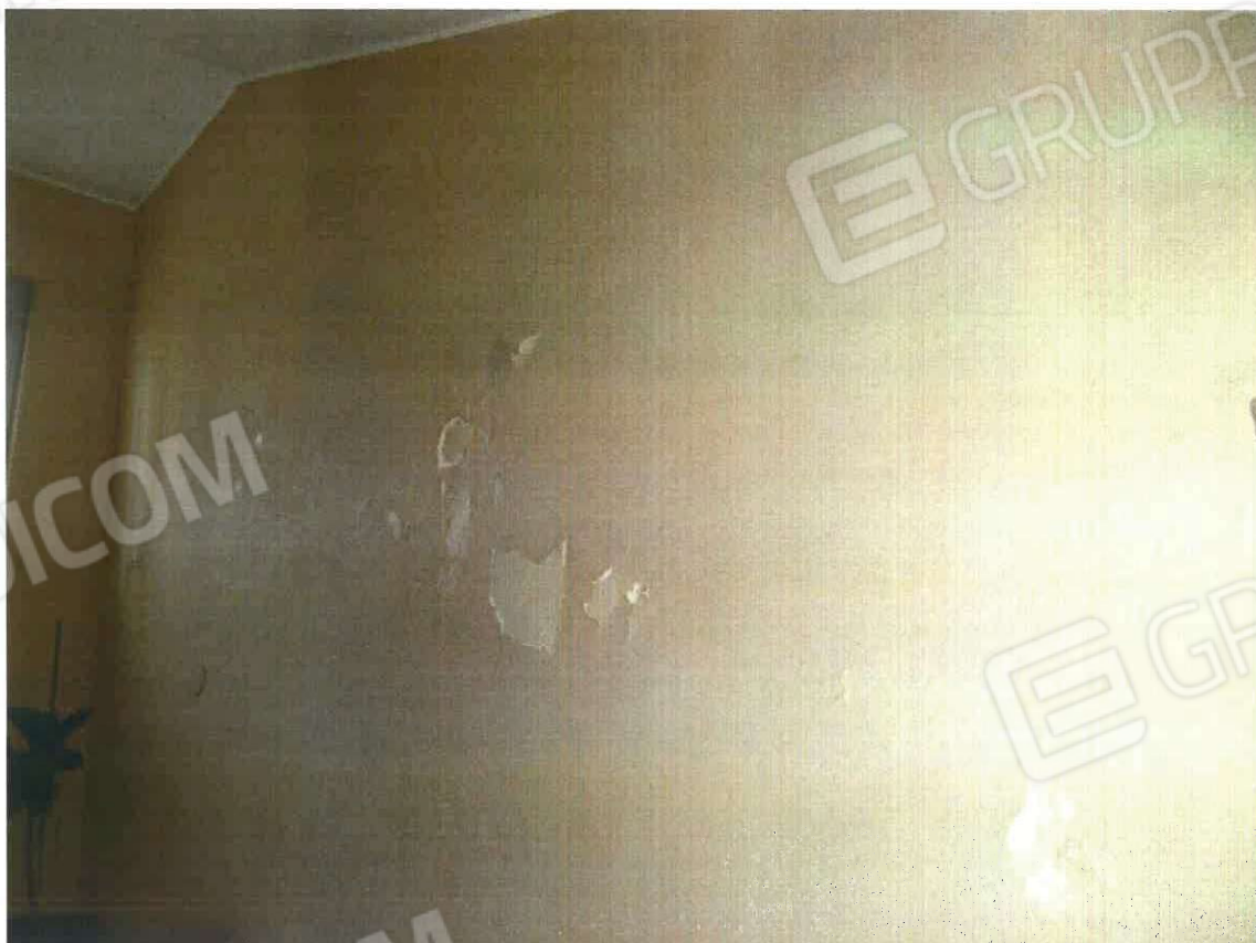
vano scale - fenomeno tipo "della scaglietta" al soffitto e parete
