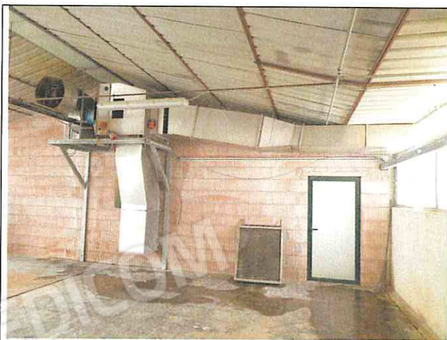
Foto n°56: Particolare impianto di trattamento aria
