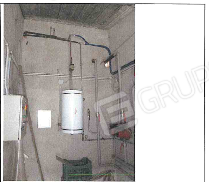
Foto n°69: Scaldabagno che gestisce i bagni interni
