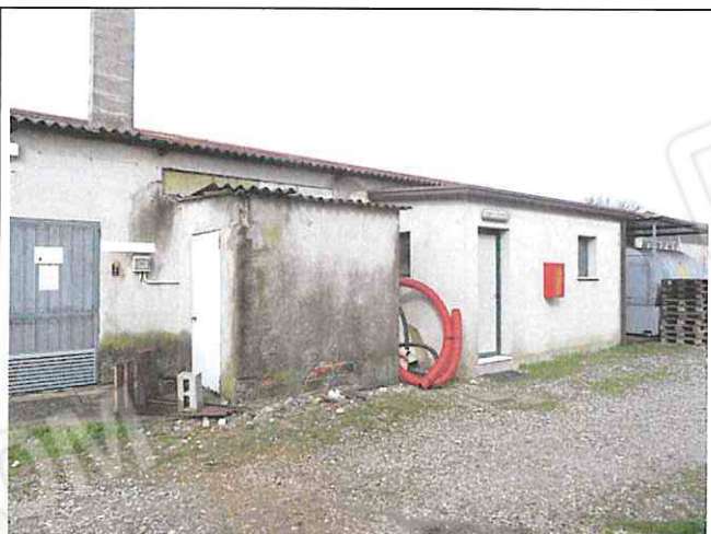
Foto n°42: Porzioni non coperte da regolare licenza
