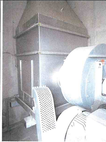
Foto n°99: Interno locale ventilatore
