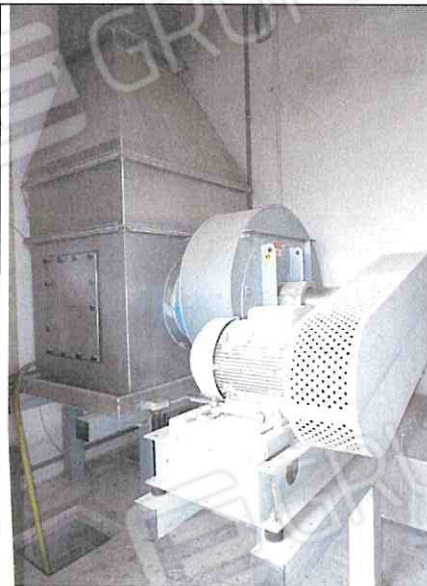
Foto n°102: Interno locale ventilatore
