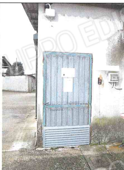
Foto n°71: Accesso alla C.T.
