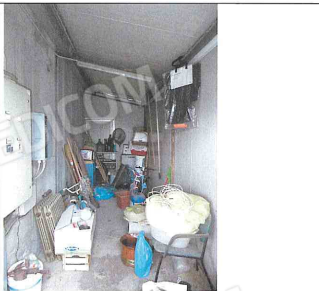
Foto n°97: Interno locale tecnico
