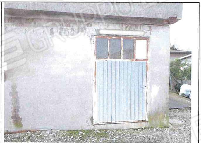
Foto n°90: Ingresso altro locale C.T.
