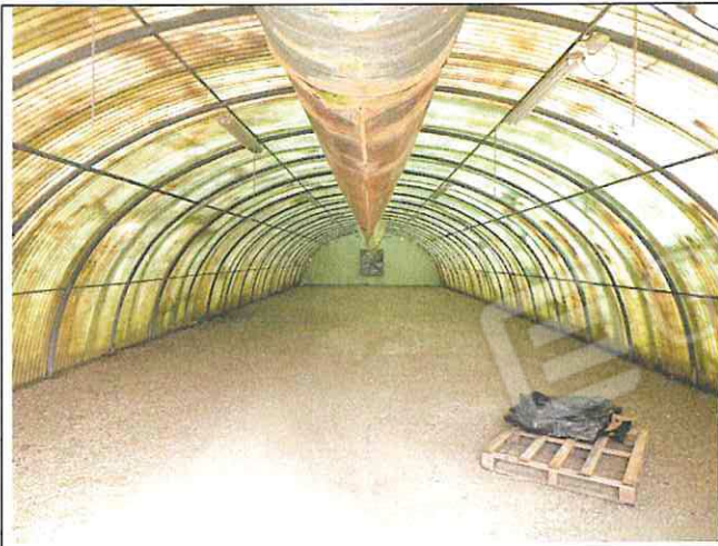
Foto n°174: Interno serra con canale aerazione
