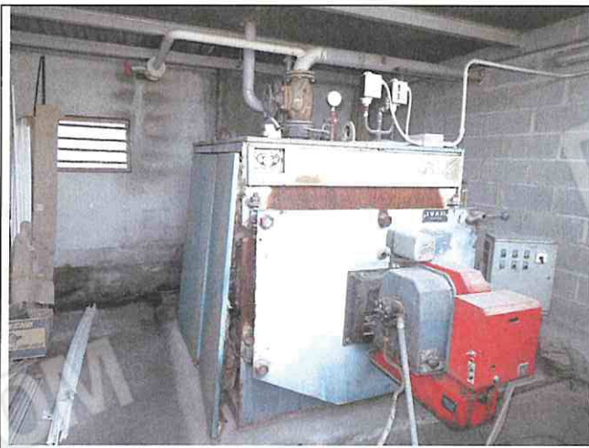
Foto n°89: Interno locale C.T.
