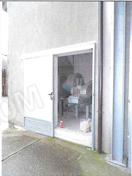
Foto n°101: Locale ventilatore ad est
