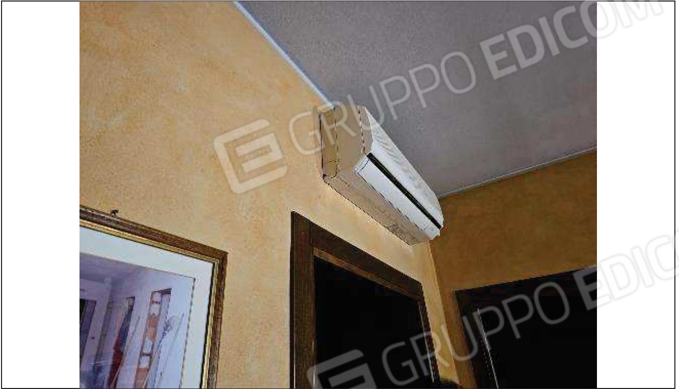
35 Vista dell'impianto di raffreddamento, posizionato sopra la porta del bagno;
