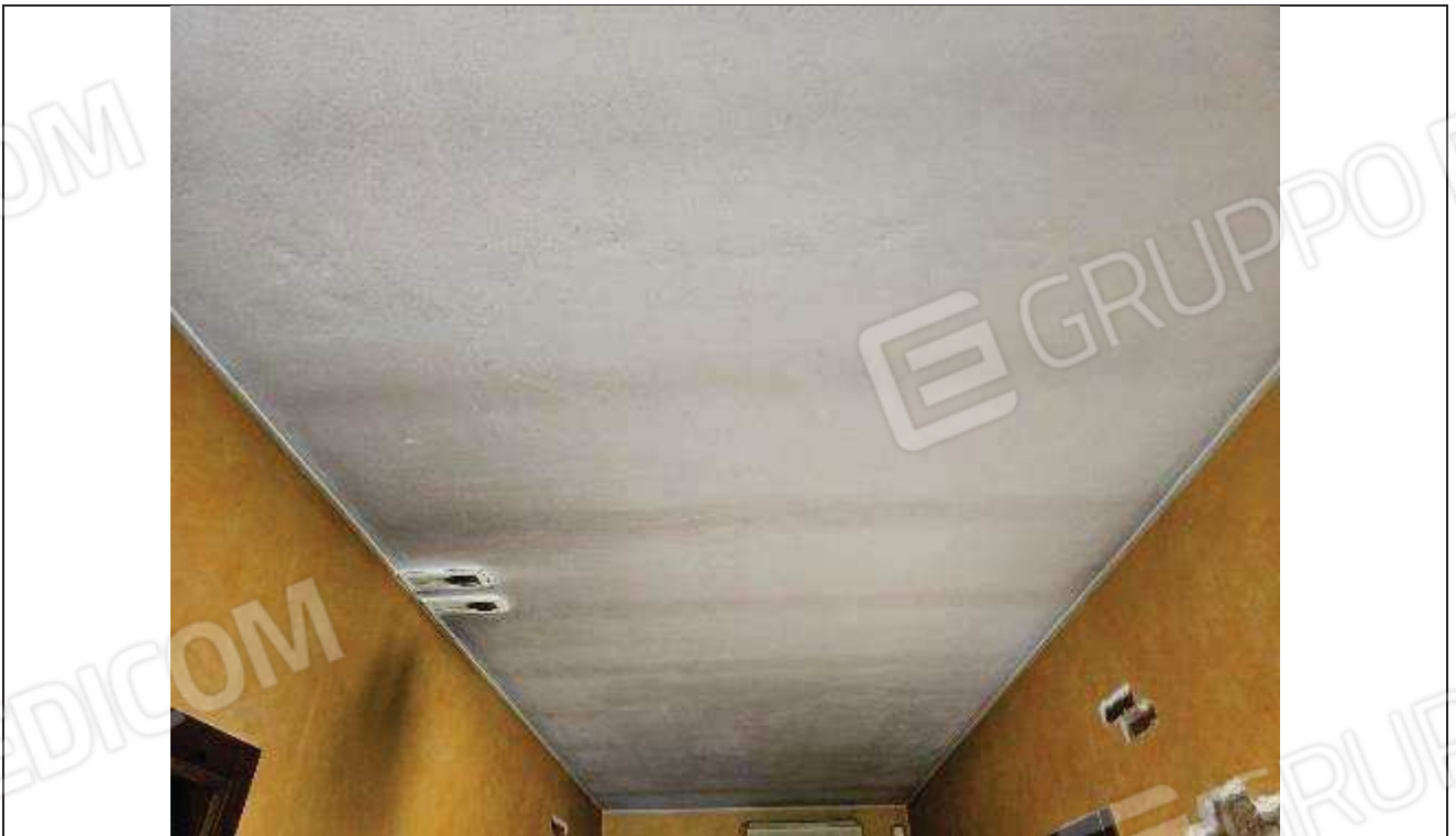
48 Particolare del soffitto del corridoio, con evidente presenza di muffe ed umidità;
