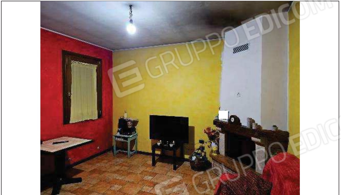
27 Vista del vano soggiorno, con presenza di umidità/muffe sul soffitto – si nota il camino installato senza autorizzazione comunale;
