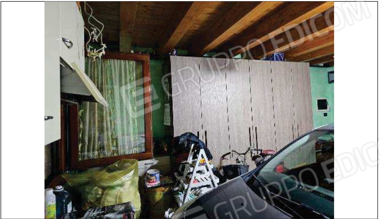
51 Altra vista interna dell' autorimessa; si nota il solaio orizzontale con travatura lignea (realizzato senza autorizzazione) che ha permesso di ricavare il soppalco abusivo, sanabile;
