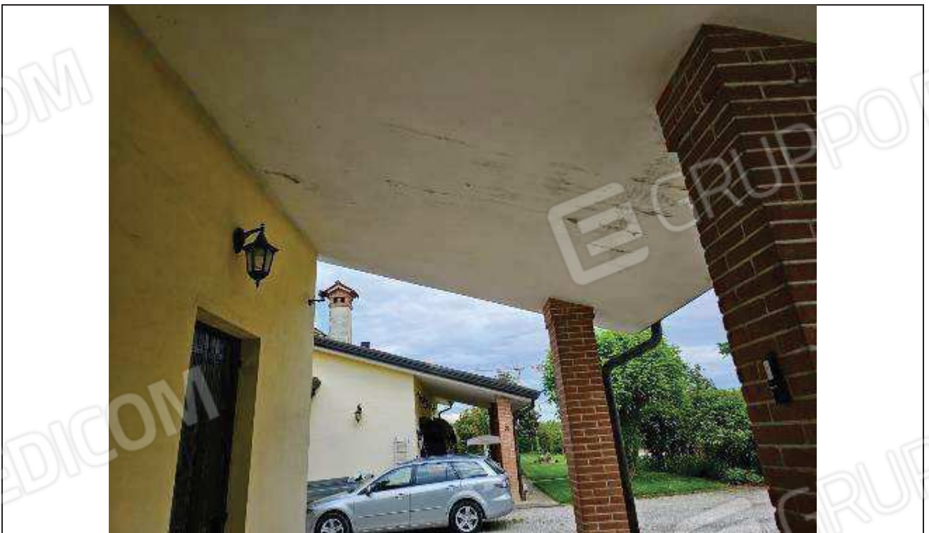
58 Particolare del soffitto del porticato con evidenti segni di distacco della tinteggiatura;
