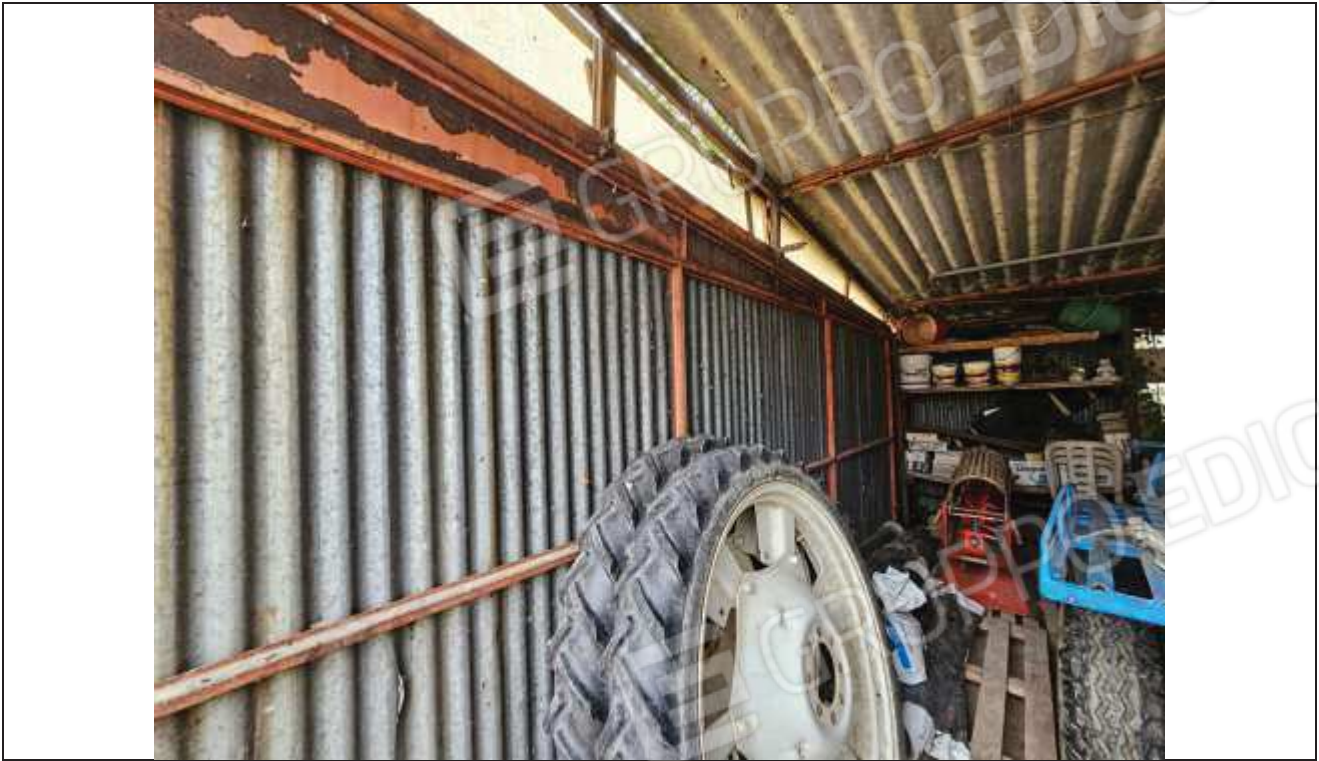
59 Vista interna del deposito attrezzi abusivo;
