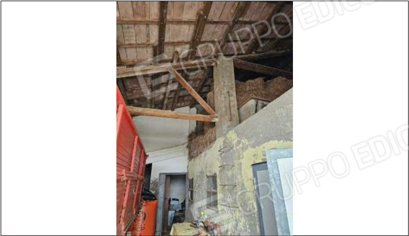
47 Vista dal portico verso il fienile collocato sopra il solaio della stalla ed accessibile mediante scale a pioli;
