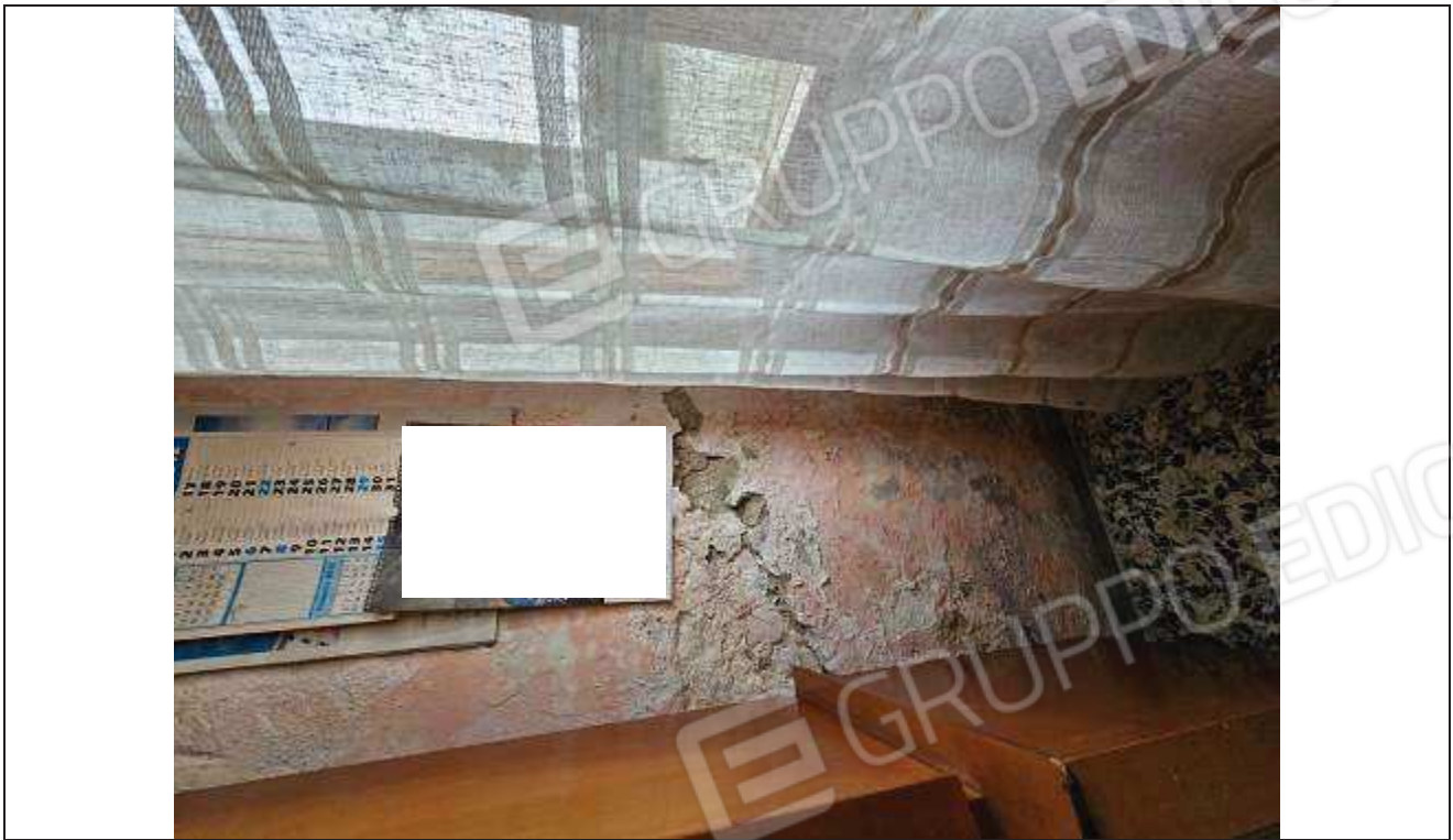
23 Particolare delle fessurazioni e del distacco dell'intonaco sulla parete interna del soggiorno;
