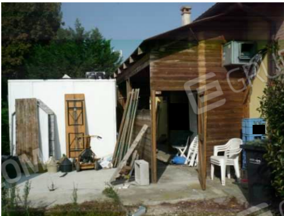
Locale ripostiglio in legno dimensioni ml 3,00 x ml 6,00 Opera abusivamente realizzata da demolire PROSPETTO SUD/EST
