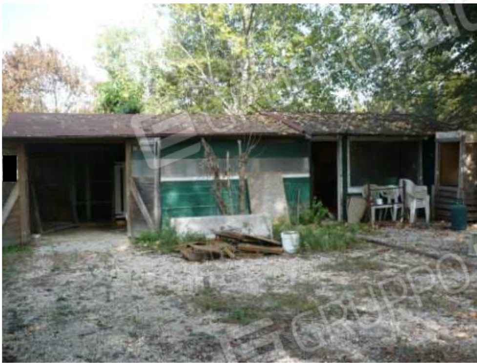
Locale ricovero attrezzi in legno dimensioni ml 4,20 x ml 11,00 Opera abusivamente realizzata da demolire PROSPETTO EST
