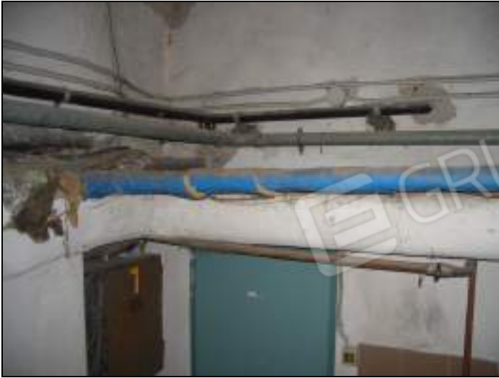
Vista parti comuni di accesso alla cantina
